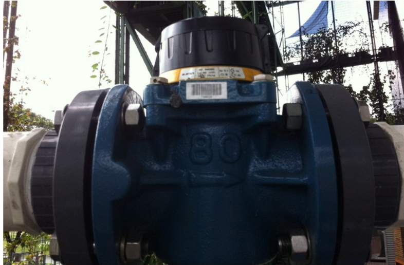
Figura 30 Contador de agua instalado para las pruebas en el laboratorio
