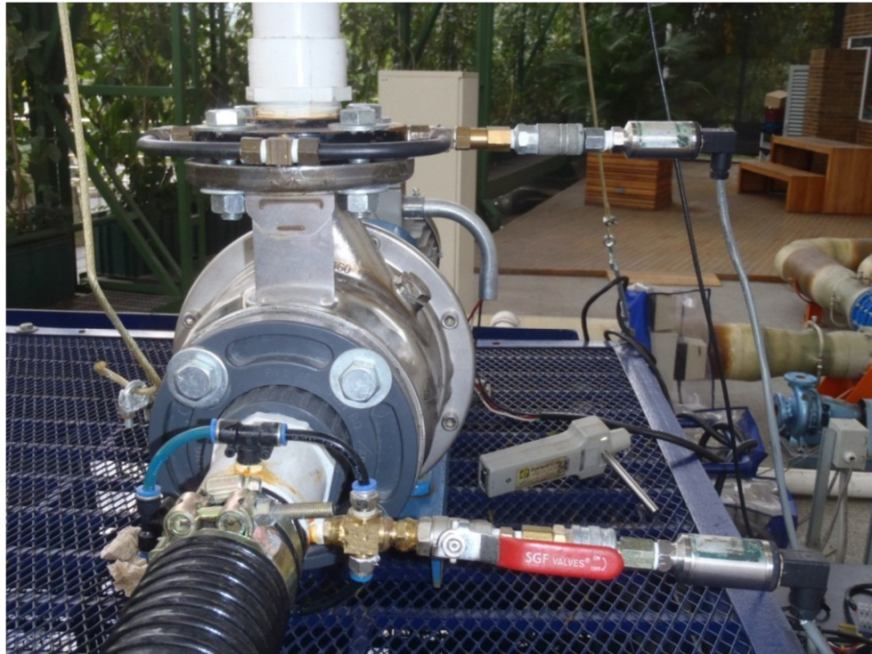
Figura 31 Sensores de presión instalados en la bomba
