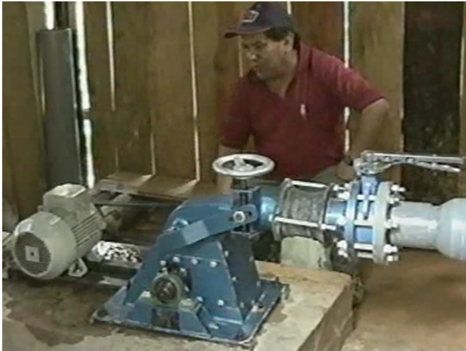
Figura 8 Fotografía cuarto de máquinas para pico central
