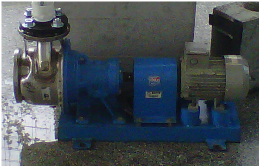
Figura 25 Bomba y motor del laboratorio de hidráulica
