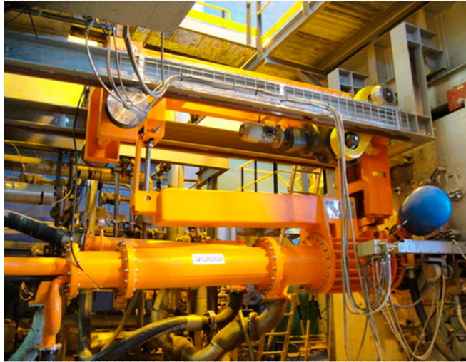
Ilustración 3. Quemador de combustible sólido pulverizado
