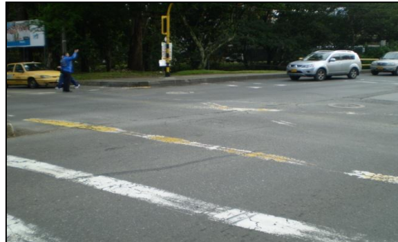
Foto 12. Estado de la pintura. Fuente: elaboración propia.
