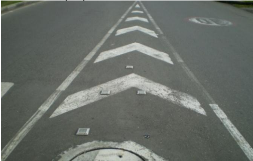
Foto 73. Perdidas de tachas reflectivas. Fuente: elaboración propia.
