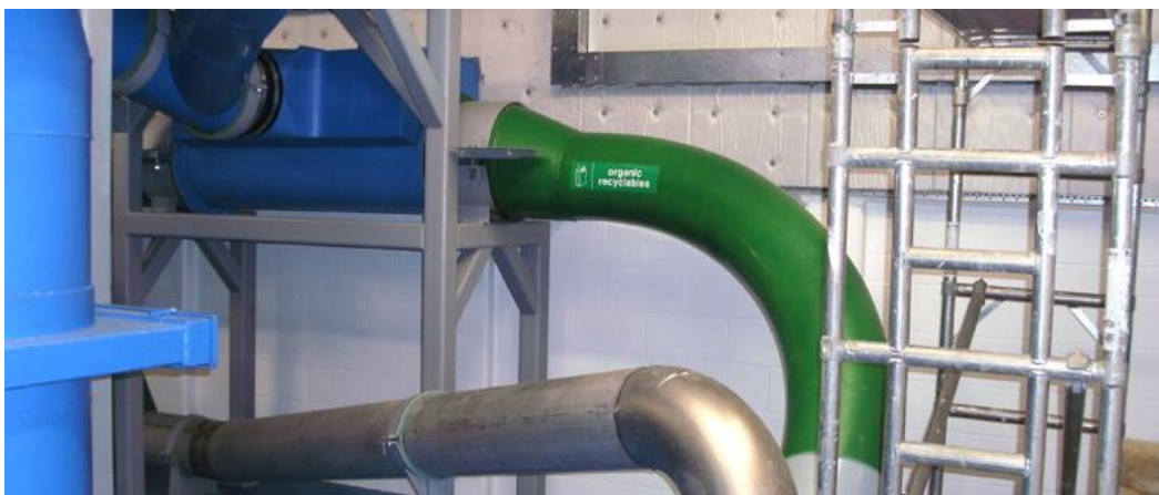
Figura 28. Sistema de ductos para la clasificación de residuos, Wembley City, Londres.
