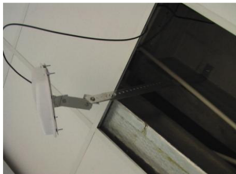
FIGURA 26 - SOPORTE ANTENAS RFID
