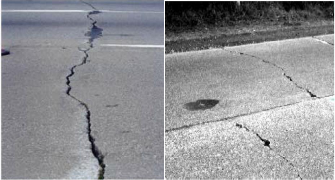
Figura 13. Fisuramiento Transversal en Losas.
