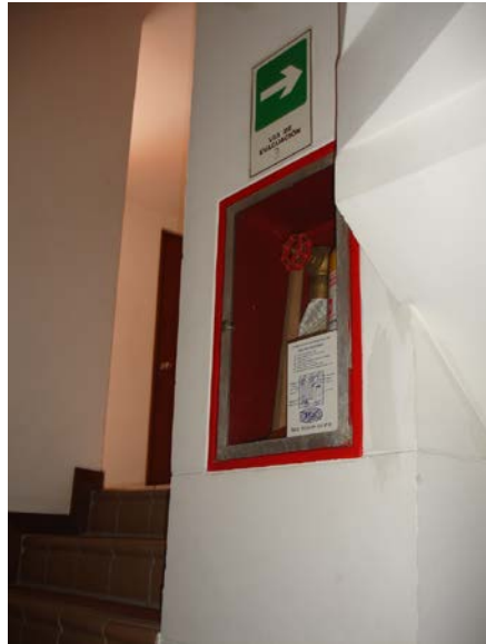
Señalización de evacuación y extintores
