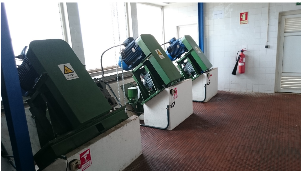
Ilustração 16 – Parafusos de Arquimedes (vista dos motores)
