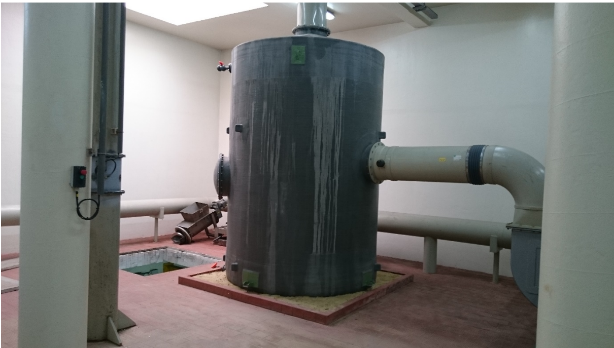
Ilustração 11 – Torre de Desodorização
