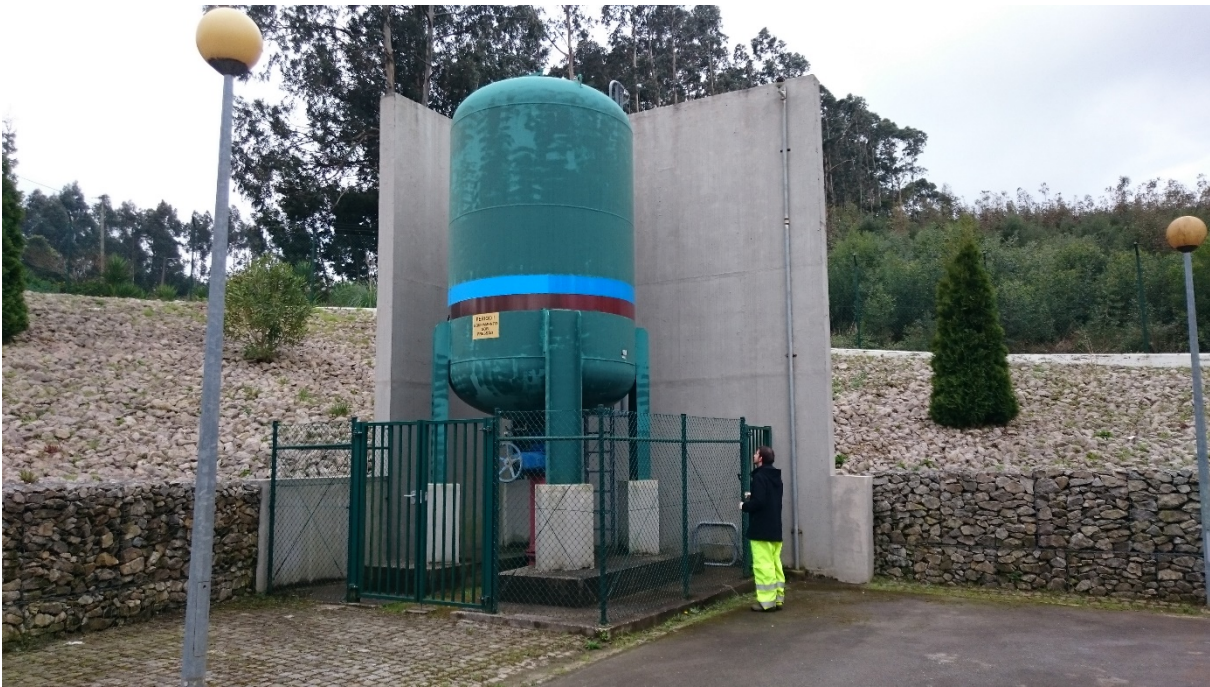
Ilustração 7 – Reservatório de ar comprimido
