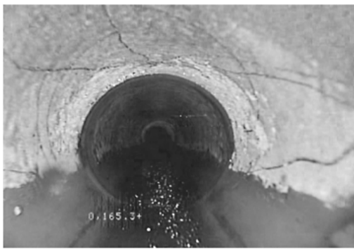
Figura 4.10 Fissura ligeira (Fonte: ASCE, 2009)
