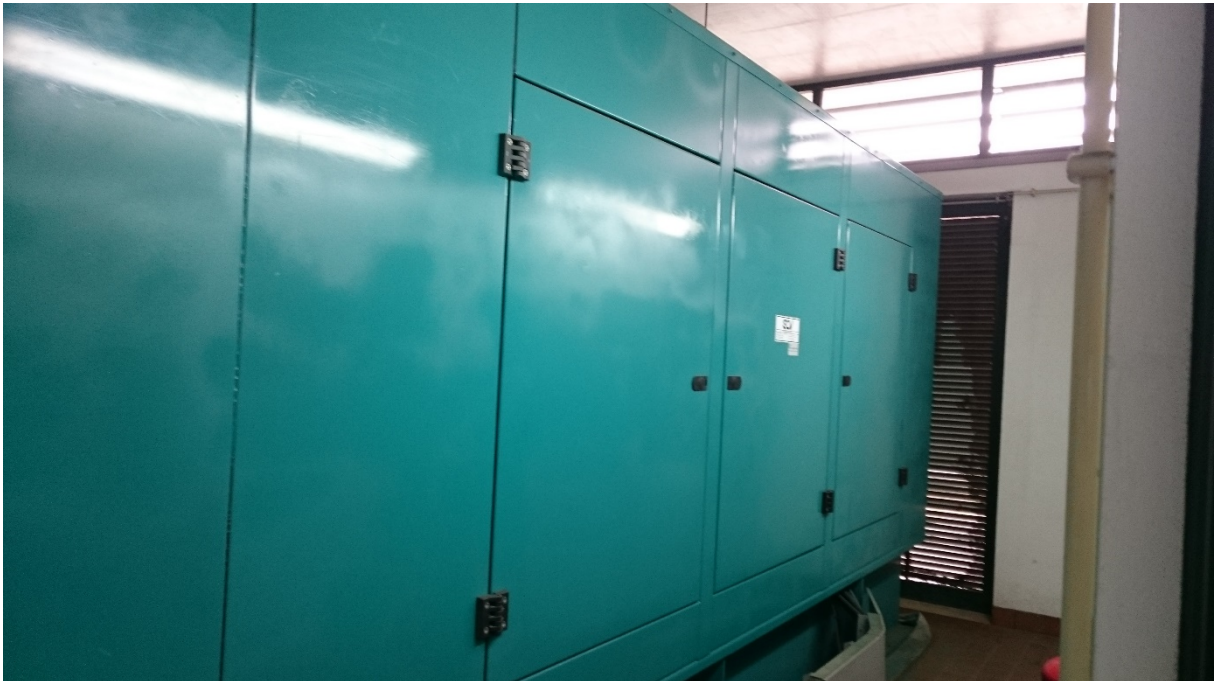
Ilustração 10 – Grupo Gerador de Emergência
