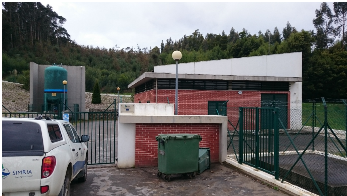
Figura 5.3 Estação Elevatória Rio Maior 1
