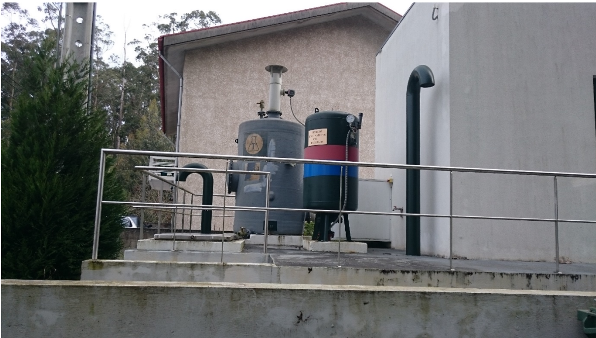
Ilustração 1 – Torre de desodorização e Reservatório de Ar Comprimido
