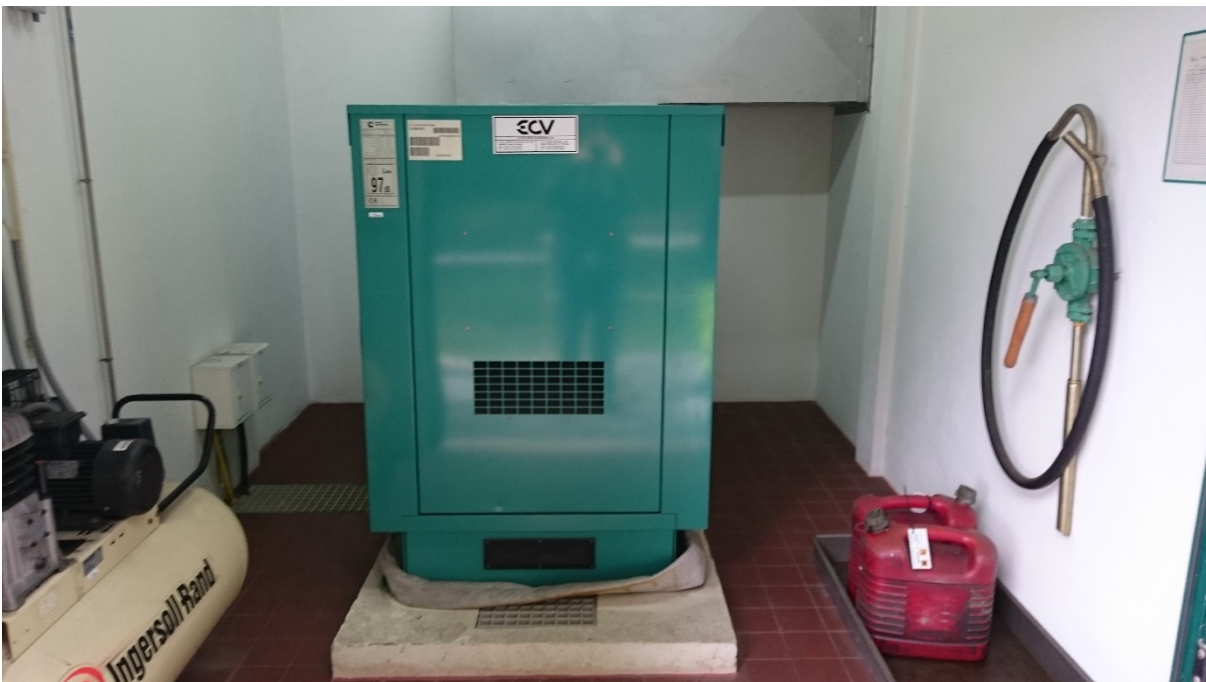
Ilustração 6 – Grupo gerador de emergência
