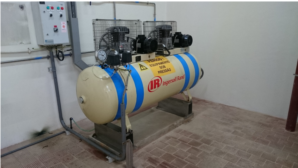
Ilustração 12 – Compressor de ar
