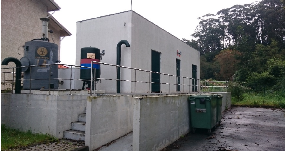
Figura 5.4 Estação Elevatória de Silvalde 1
