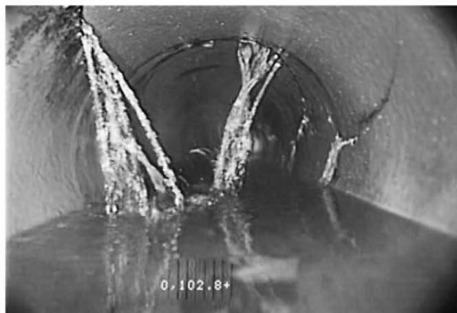
Figura 4.12 Fissura com infiltração elevada (Fonte: ASCE, 2009)
