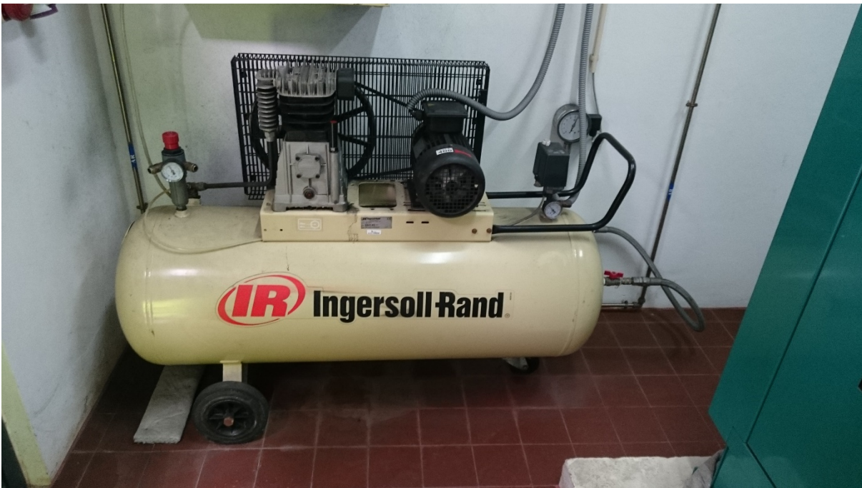
Ilustração 5 – Compressor de ar
