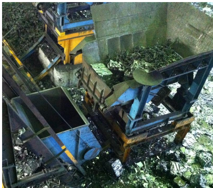
Figura 91 – Balança Vibratória e Skip de Elevação
