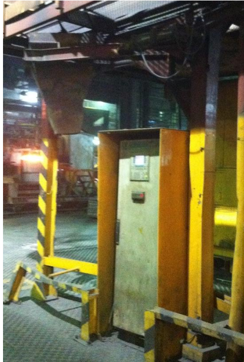
Figura 94 – Estação de Pesagem de Aditivos KUTTNER
