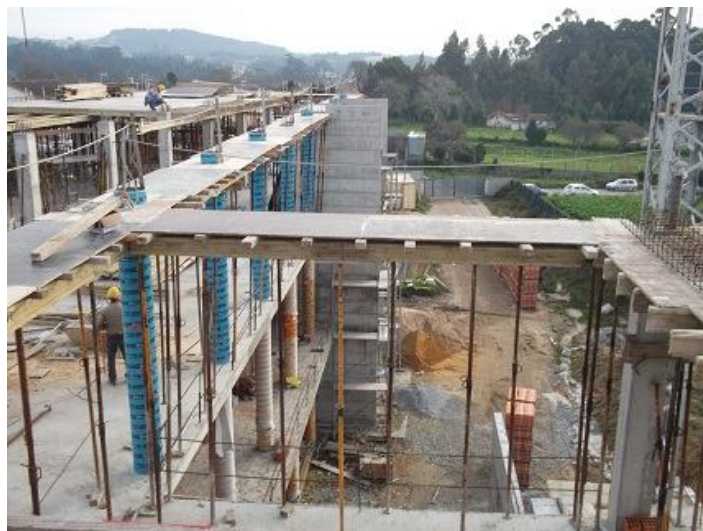
Figura 20 - Aplicação de armadura em vigas de laje de cobertura (cedida pela empresa)
