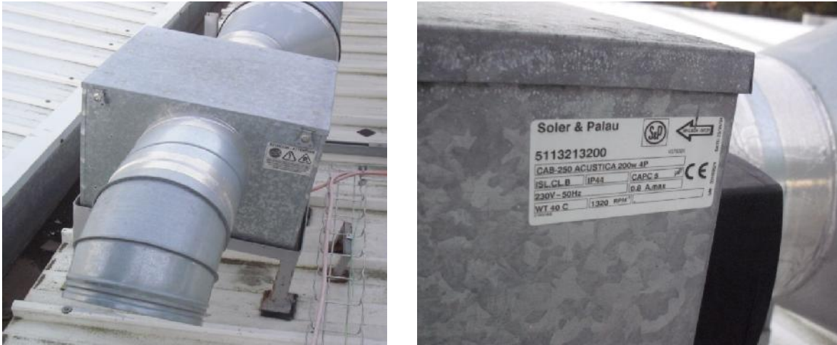
Figura 28 Controlo de abertura e fecho de registos das salas de formação
