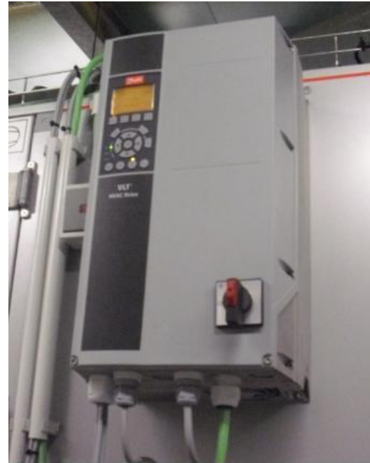
Figura 34 Variador de frequência do ventilador de extração da UTA 1
