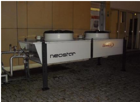
Figura 17 Chiller “Água – Água” existente no ECOTERMOLAB
