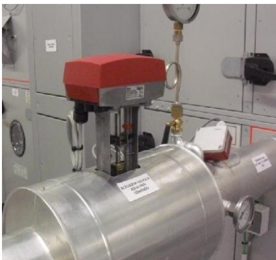
Figura 35 Válvula 3 vias modulante (0-24V) e sonda de temperatura água fria
