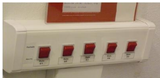
Figura 23 Controlo de abertura e fecho de registos das salas de formação
