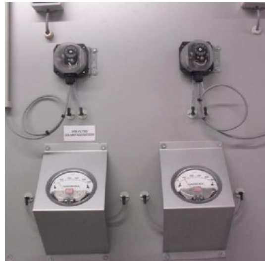
Figura 36 Pressostátos diferenciais para verificação da colmatção dos filtros
