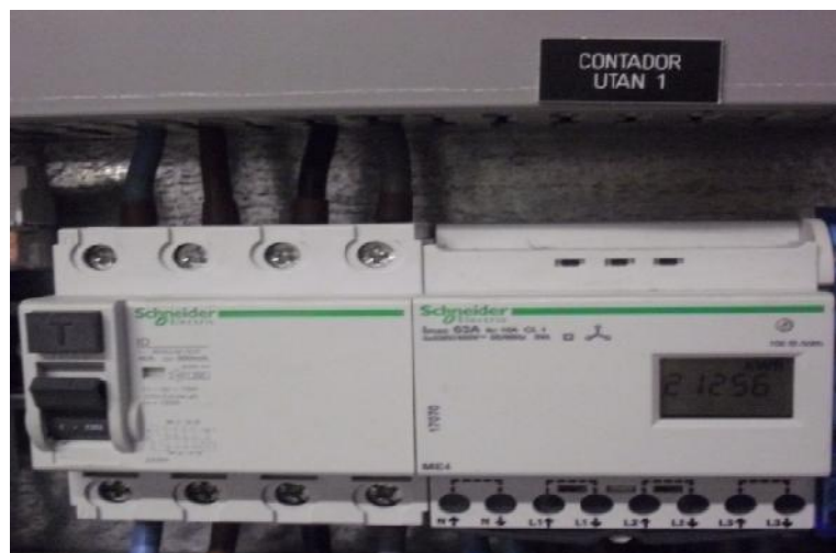
Figura 45 Contador de energia elétrico UTA 1
