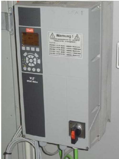
Figura 33 Variador de frequência do ventilador de insuflação da UTA 1
