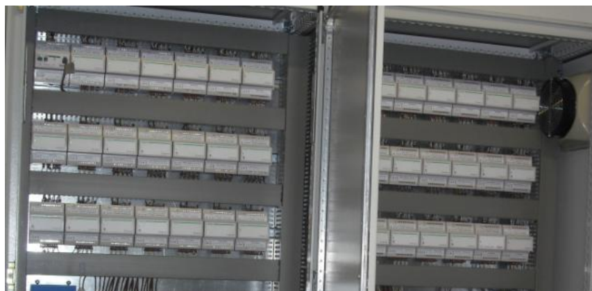
Figura 29 Controladores DDC e módulos de entrada/saída (Q.E. AVAC)
