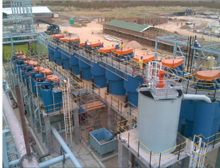
Figura 18 - Instalação com beneficiamento por flutuação - células de flutuação ( http://www.mining-technology.com/contractor_images/4056/images/138941/large/BQR-Flotation-Cells.jpg , 2014).
