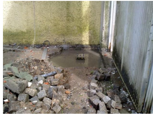
Figura 4.22: Ascensão de água na sapata S2
