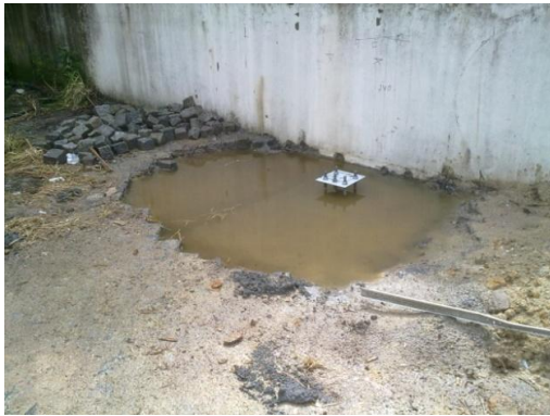
Figura 4.21: Ascensão de água na sapata S2
