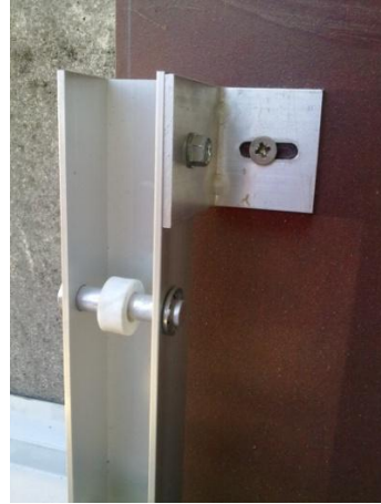
Figura 3.77: Subestrutura da fachada
