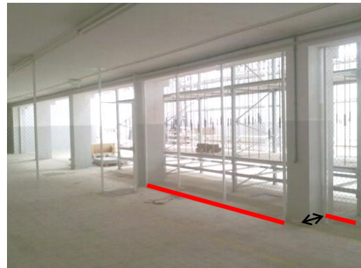
Figura 4.93: Desalinhamento da rede de vedação
