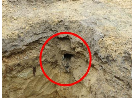
Figura 4.18: Ramal de ligação de água pluvial interrompido - Sapata S2
