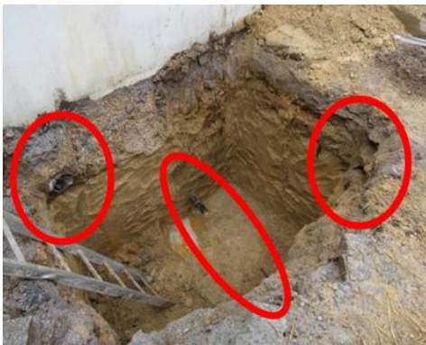
Figura 4.15: A vala da Sapata S2- localização dos cortes dos ramais de ligação de águas pluviais
