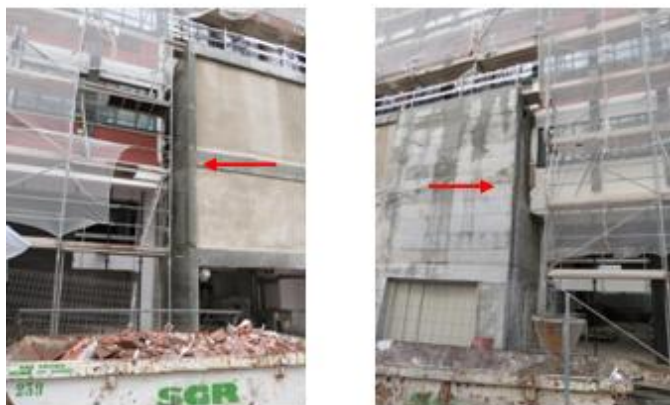
Figura 3.6: Verticalidade da fachada
