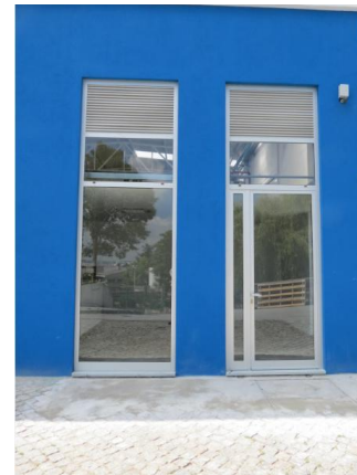
Figura 4.59: Caixilharia aplicada na obra - vãos exteriores
