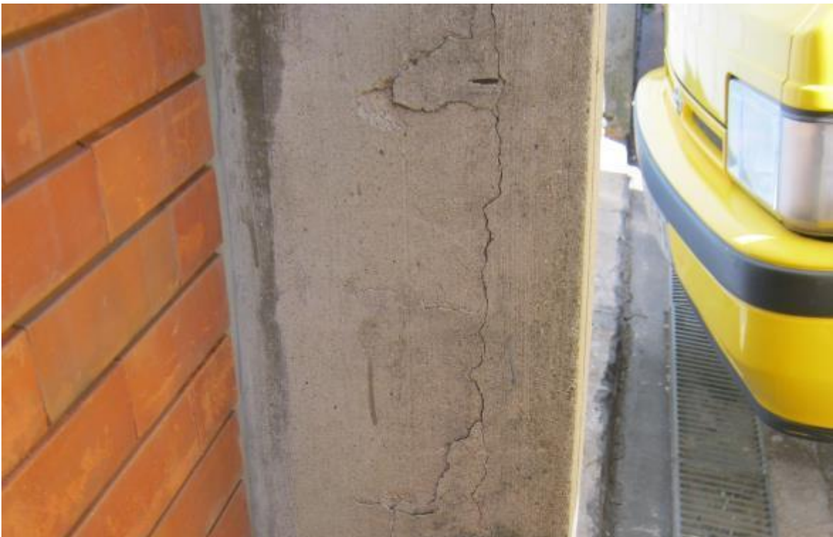
Figura 45 - Fissuração superficial passiva.
