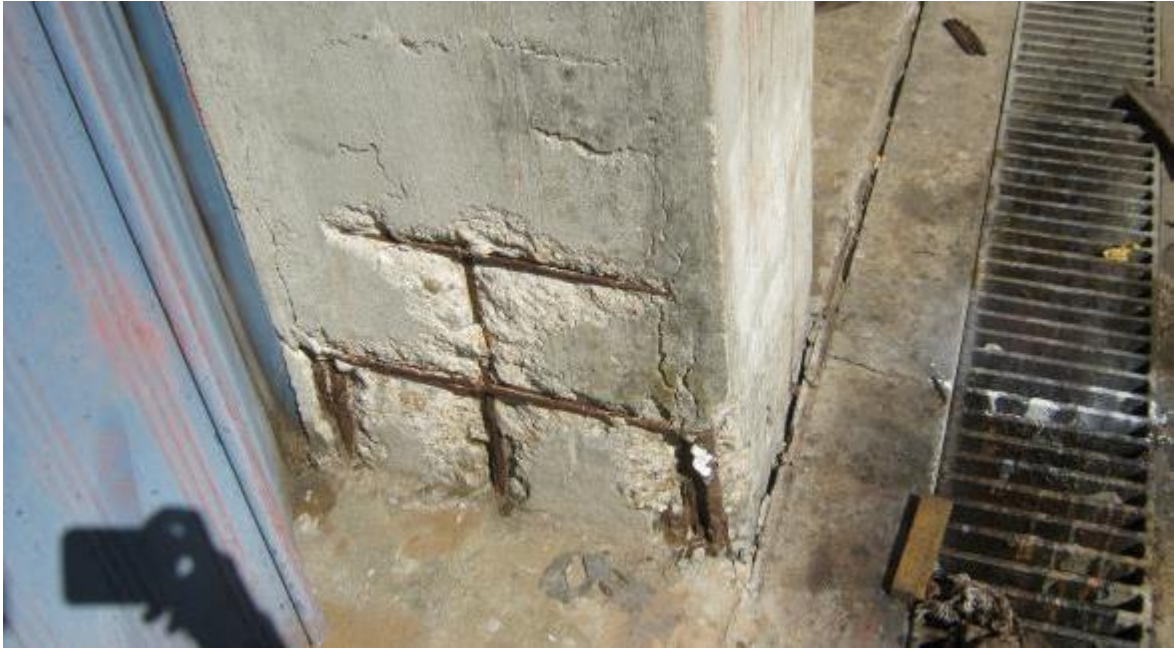
Figura 44 - Delaminação superficial com exposição de armaduras.
