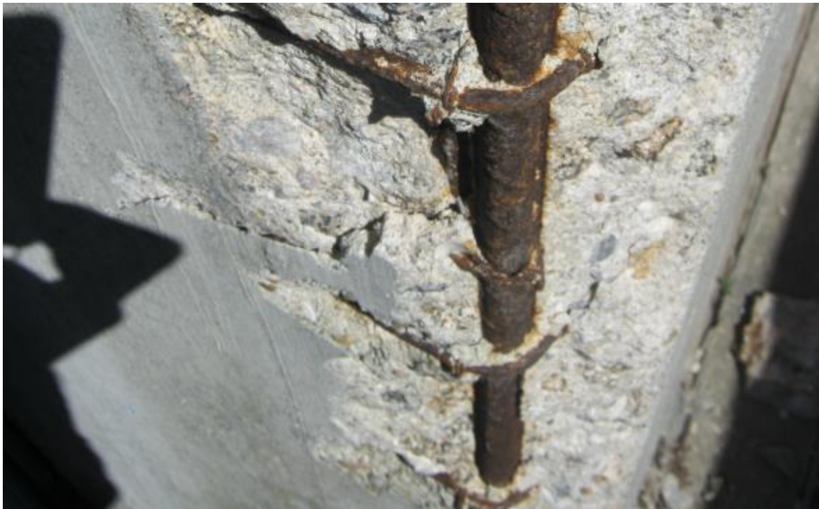
Figura 39 - Betão com corrosão ativa das armaduras.
