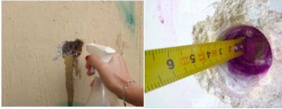
Figura 11 - Determinação da profundidade de carbonatação ( www.oz-diagnosticos.com ).
