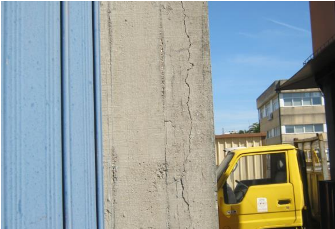
Figura 46 - Fissuração superficial passiva.
