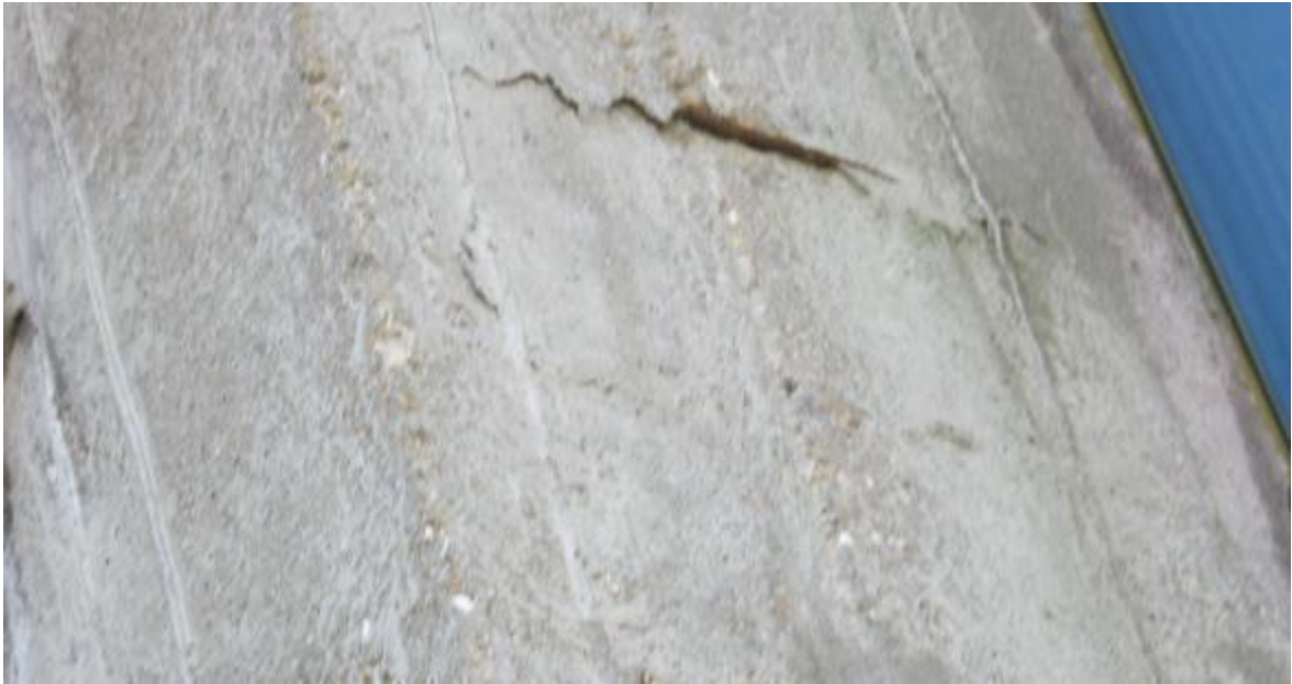
Figura 40 - Delaminação ou escamação superficial do betão.
