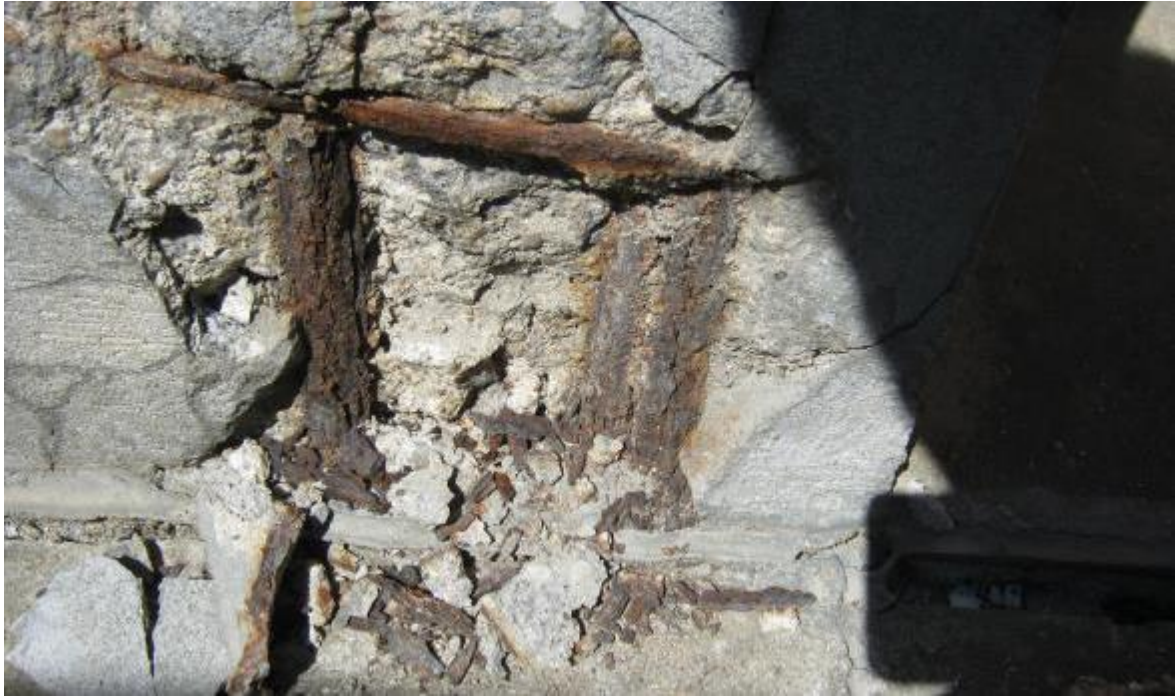
Figura 38 – Betão com corrosão ativa das armaduras.
