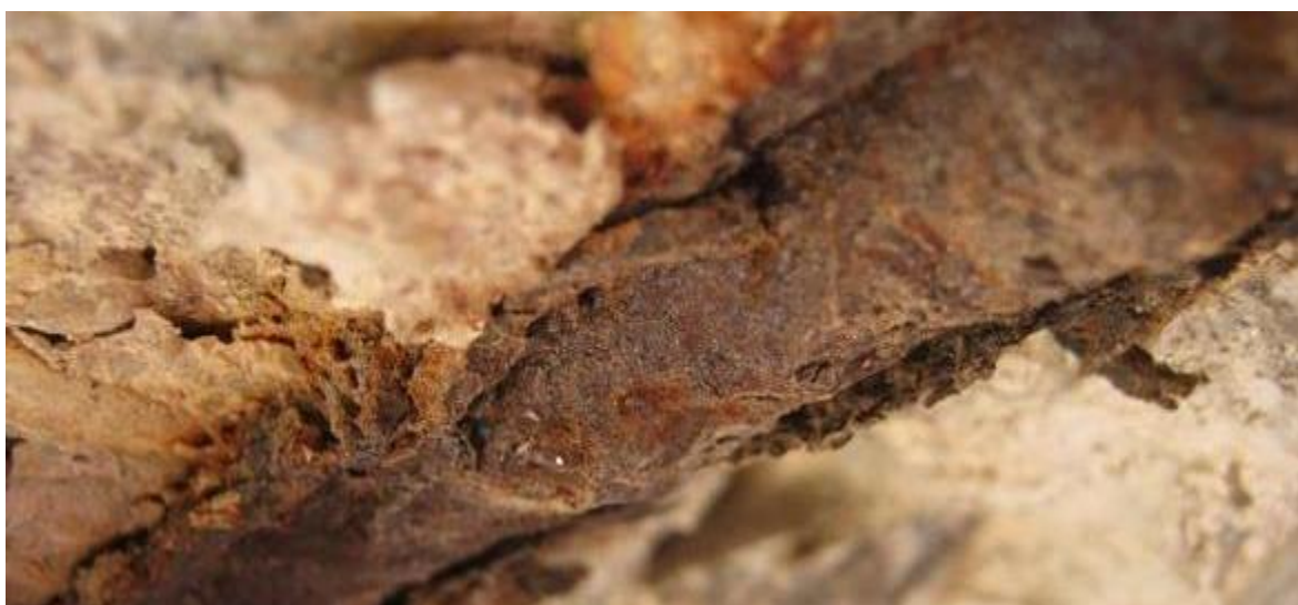
Figura 37 – Betão com corrosão ativa das armaduras.
