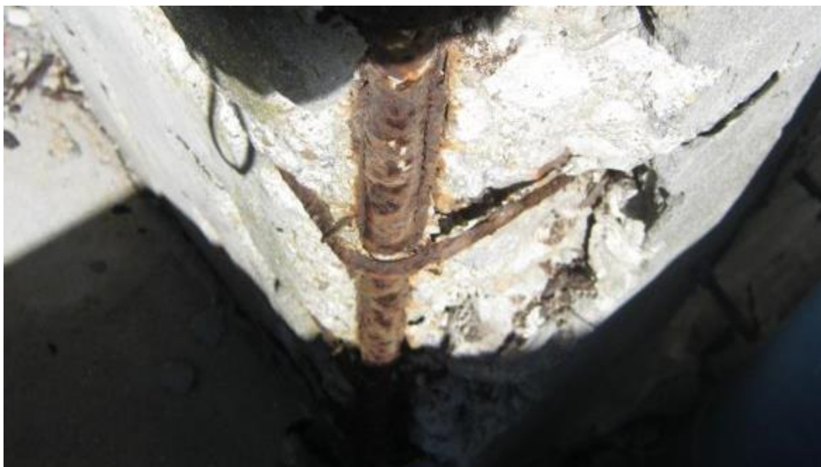
Figura 42 - Delaminação superficial com exposição de armaduras.
