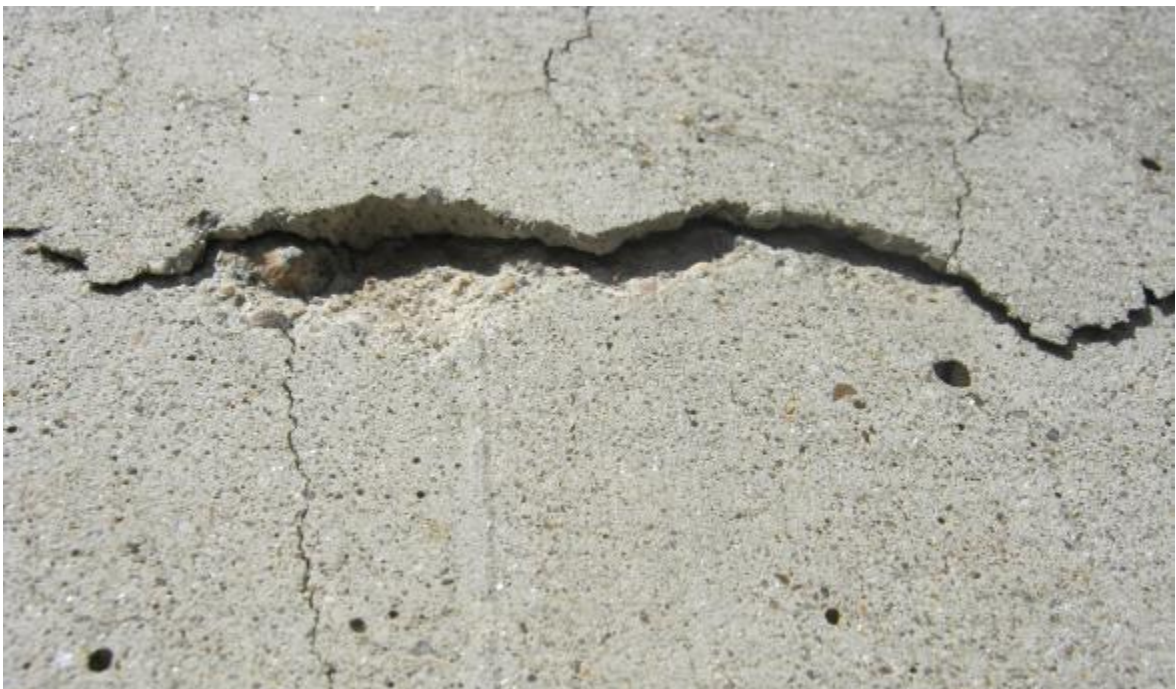
Figura 41 - Delaminação ou escamação superficial do betão.
