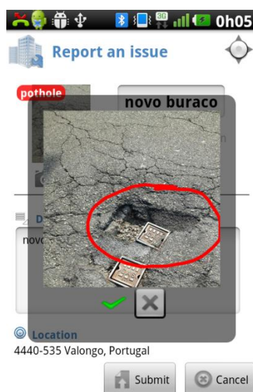
Figura 23 – Aplicação móvel – Demarcação manual de patologia na estrada
