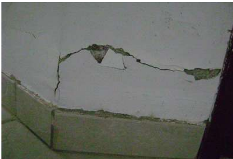
Figura 15 Exemplo de aplicação de adesivos estruturais acrílicos metacrilatos numa fissura [15].
