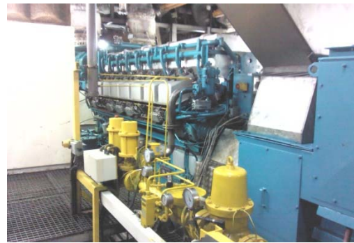
Figura 4 – Motor de combustão instalado no Norteshopping
