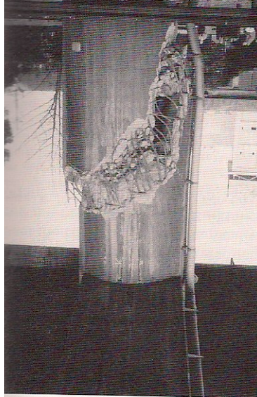
Figura 146 – Danificação de um pilar por acção sísmica
