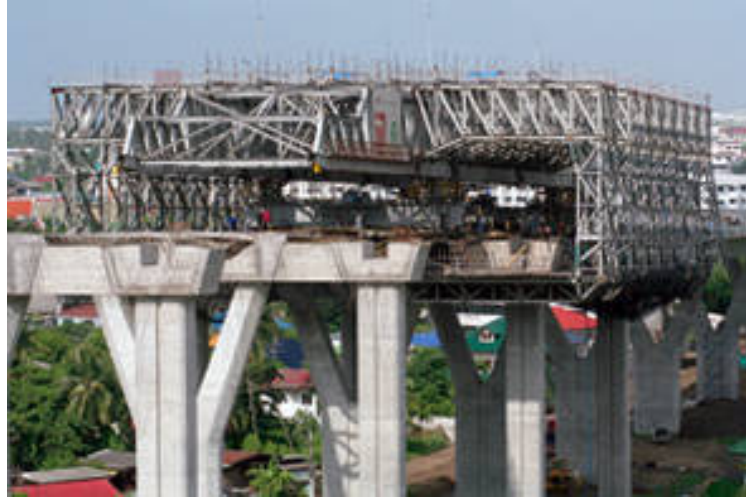
Figura 103 – Viga de lançamento superior
