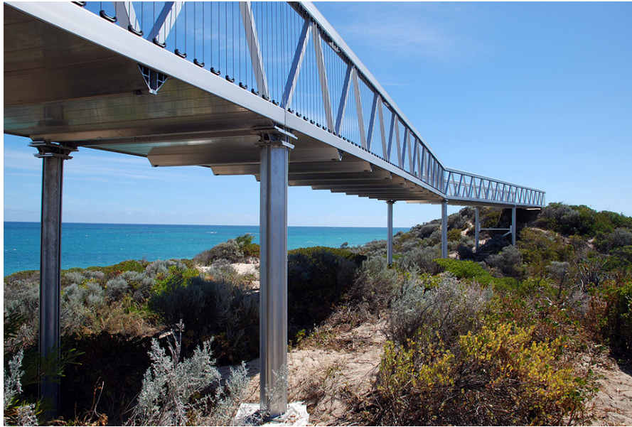
Figura 36 – Passagem em alumínio
