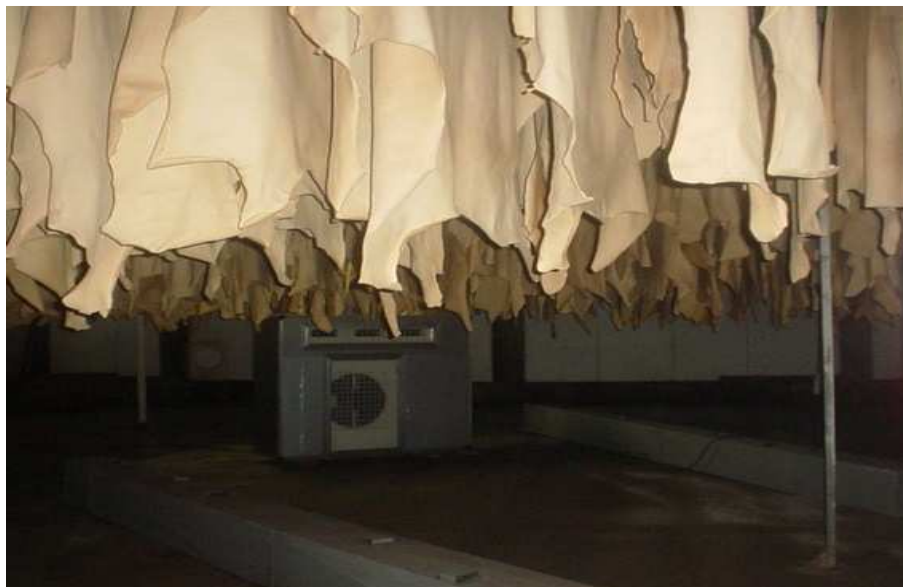
Figura 4.3.3. Desumidificador a 13,8 m da caldeira
