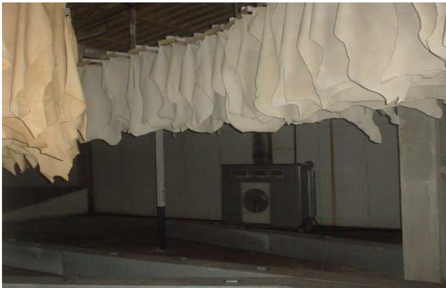
Figura 4.3.2. Desumidificador a 8,3 m da caldeira
