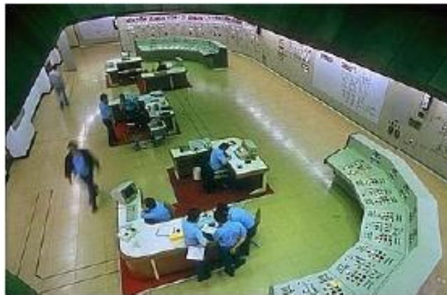
Figura 2 Exemplo de uma central de controlo
