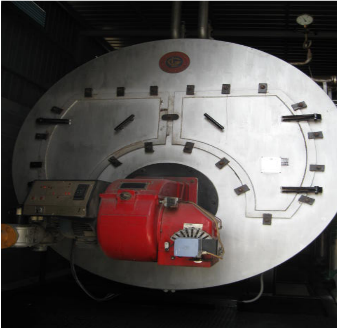
Figura 1.10 -Caldeira tubos de fumo que produz vapor saturado para toda a fábrica.
