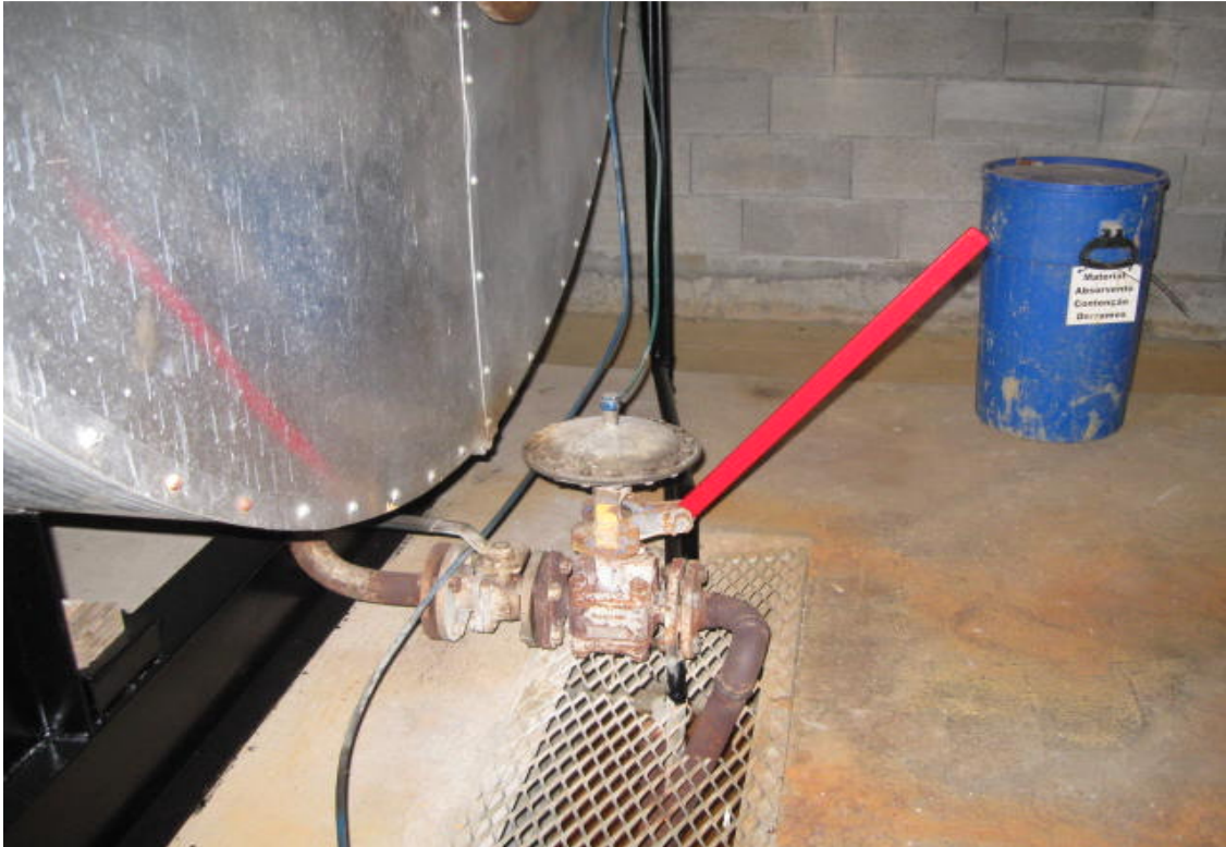
Figura 4.1- Válvula da purga de fundo.
