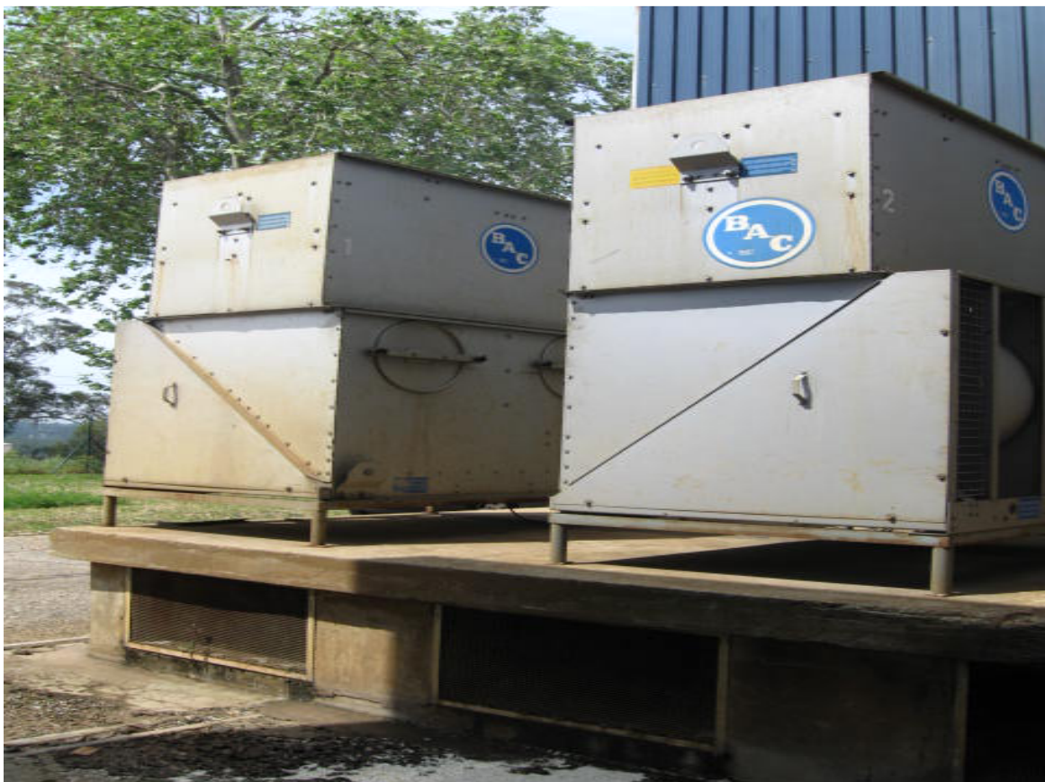
Figura 1.11- Torres de arrefecimento.
