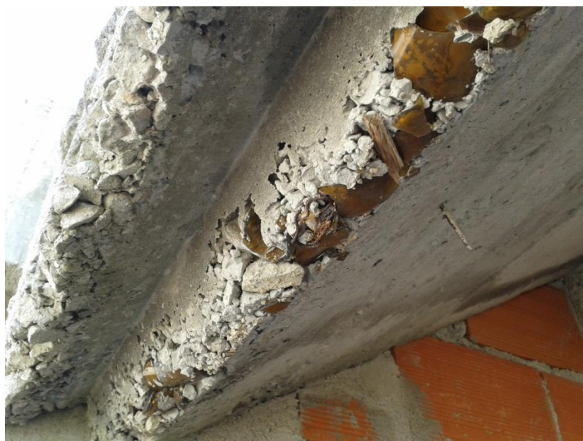
Figura 15 - Lixo nos moldes aquando da betonagem
