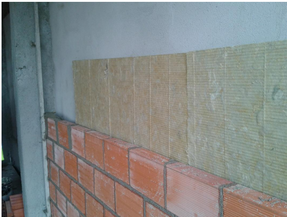
Figura 17 – Isolamento acústico utilizado entre moradias vizinhas
