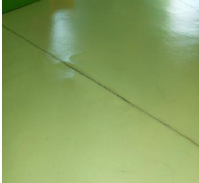
Figura 68 - Alteração nas juntas de um revestimento de linóleo [35]
