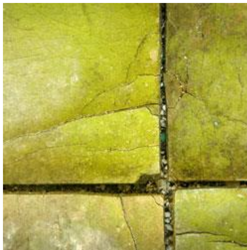
Figura 64 - Apodrecimento do revestimento de linóleo [36]
