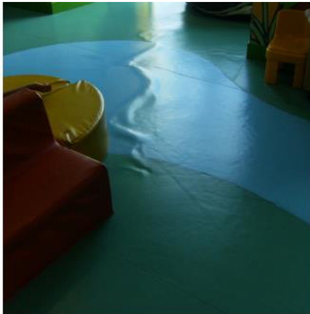
Figura 65 - Empolamento de um revestimento de linóleo [35]
