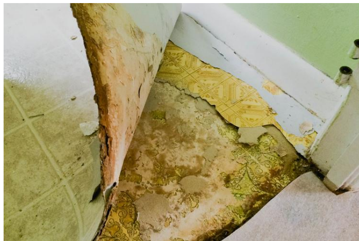
Figura 66 - Descolamento de um revestimento de linóleo [37]
