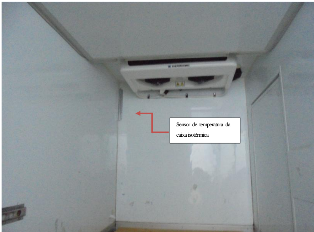
Fig. 3 - Interior da caixa isotérmica, com equipamento de frio e sensor de temperatura
