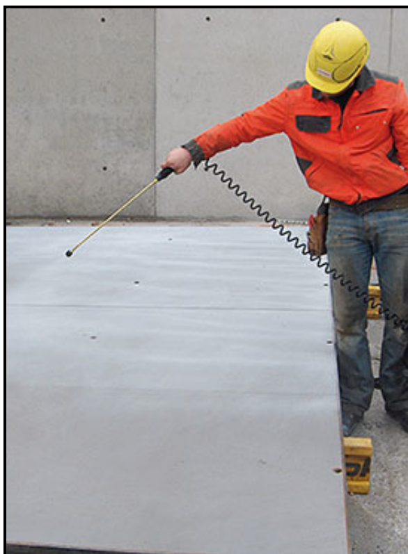
Figura 5-4 Exemplo de aplicação de óleo descofrante com recurso a pulverizador (foto: DOKA)
