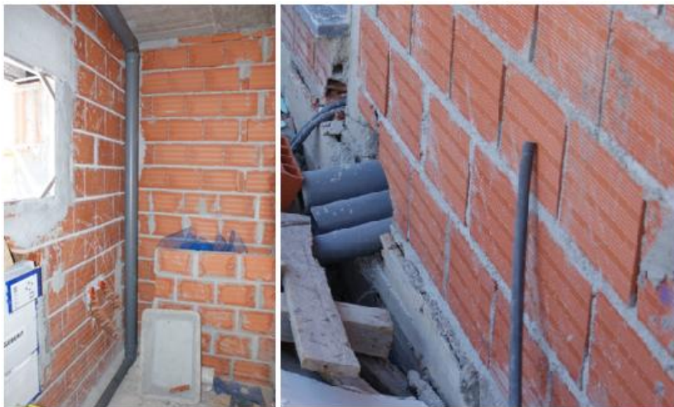
Figura 39 - Tubos de Águas Residuais
