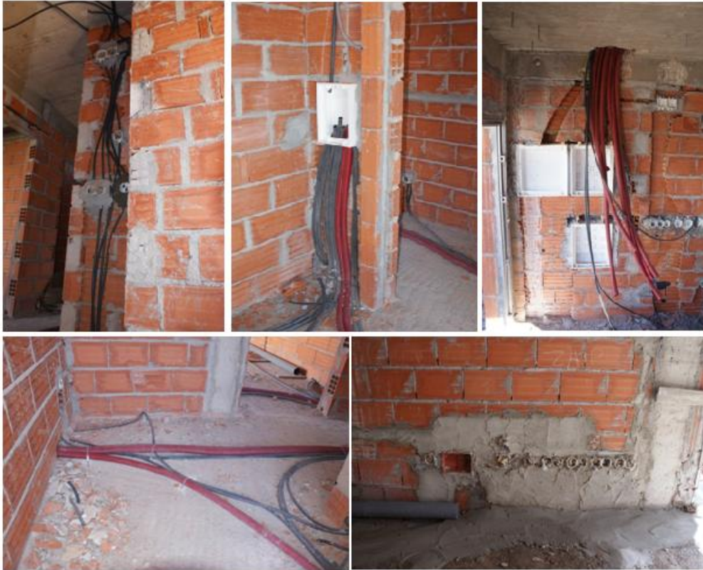
Figura 40 - Pré-instalação Eléctrica e de ITED
