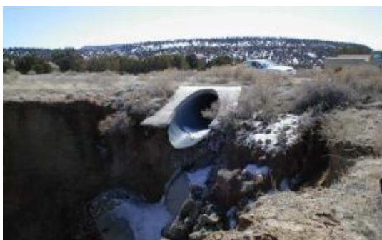
a: Erosão à saída de passagem hidráulica antes da aplicação de gabiões como proteção
