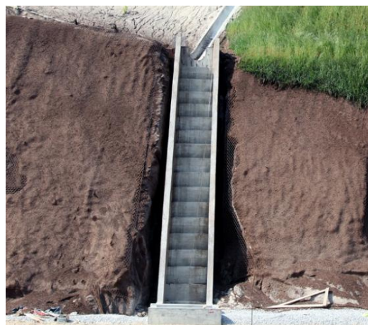
Figura 3.24: Exemplo de uma estrutura de dissipação por degraus numa descida de talude (cedida pelo Engenheiro António Calixto)
