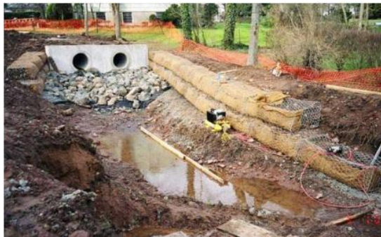
Figura 2.1: Erosão a jusante de uma passagem hidráulica (extraído de Maccaferri, 2004)
