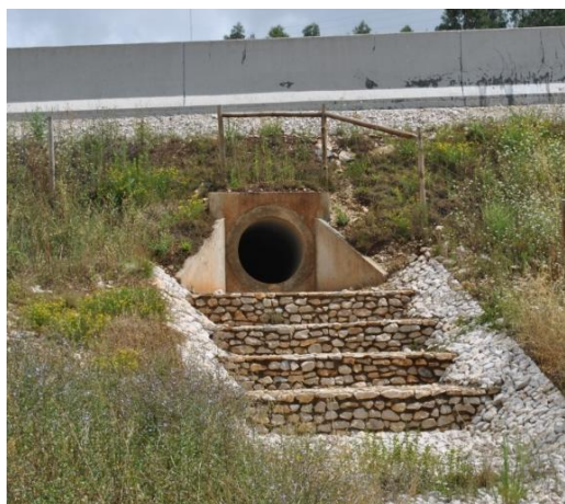
Figura 3.23: Exemplo de uma estrutura de dissipação por degraus a jusante de uma passagem hidráulica (junho 2014, acervo da autora)
