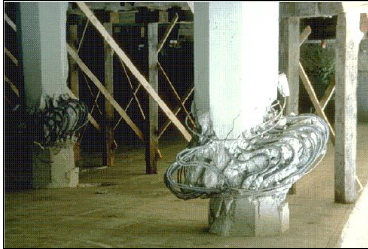
Figura 2.20 – Rotura por esmagamento do betão - falta de cintagem [16]
