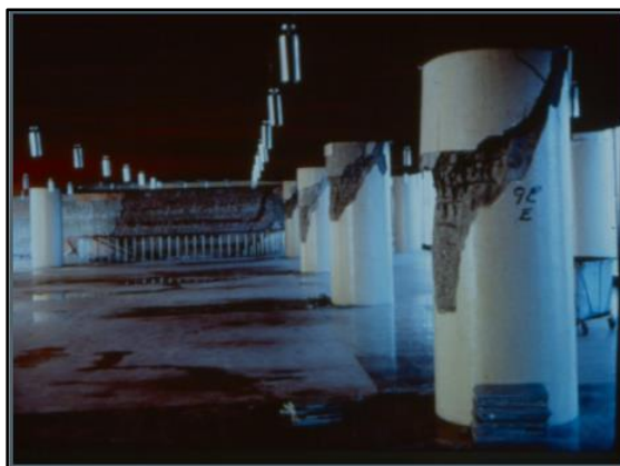
Figura 2.24 – Rotura frágil por esforço transverso [14]
