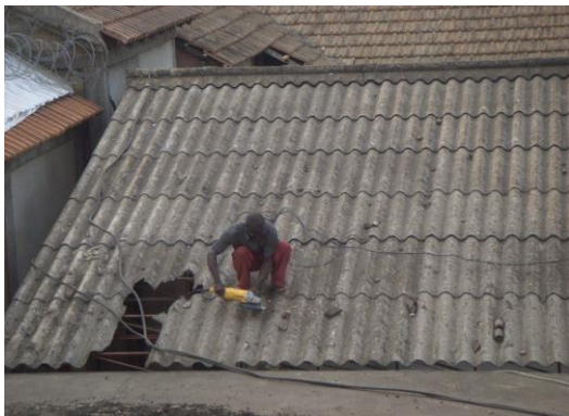
Foto 75 – Remoção de fibrocimento sem qualquer tipo de equipamento colectivo ou individual. Corte de grampos com máquina de disco.
