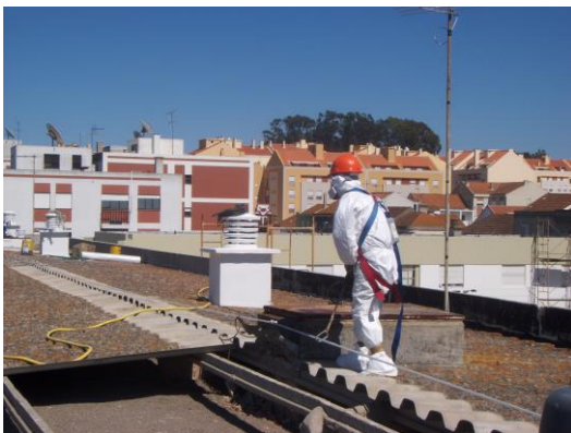
Foto 33 – Remoção de fibrocimento pelo exterior. Aplicação da solução aquosa para o encapsulamento, com recurso a pulverizador.
