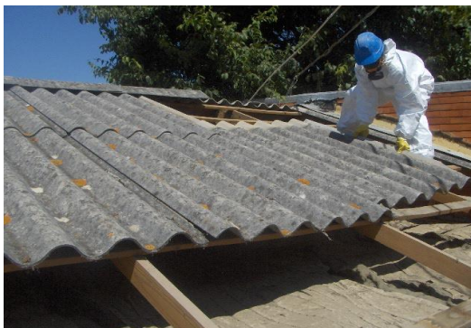
Foto 73 – Remoção de chapas de fibrocimento sem tratamento com solução aquosa de encapsulamento.
