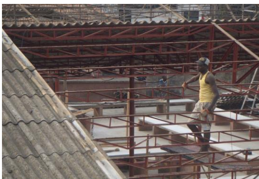
Foto 77 – Remoção de fibrocimento sem qualquer tipo de equipamento individual.
