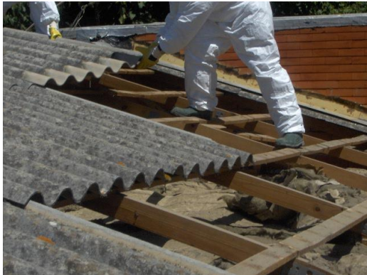
Foto 74 – Chapas de fibrocimento sem tratamento com solução aquosa de encapsulamento. Risco de queda em altura do trabalhador.
