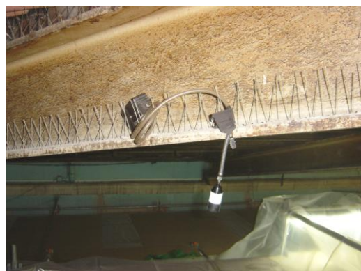
Foto 53 – Aparelhos para monitorização e avaliação, numa zona da cobertura, durante a execução dos trabalhos, para determinar a concentração de amianto no ar.
