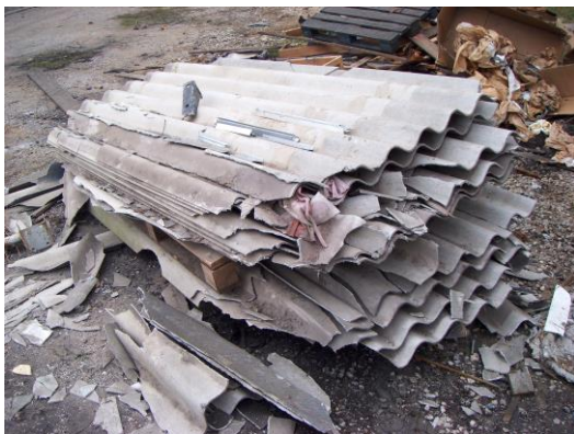
Foto 68 – Chapas partidas, com alto risco de inalação de fibras, durante o manuseamento.
