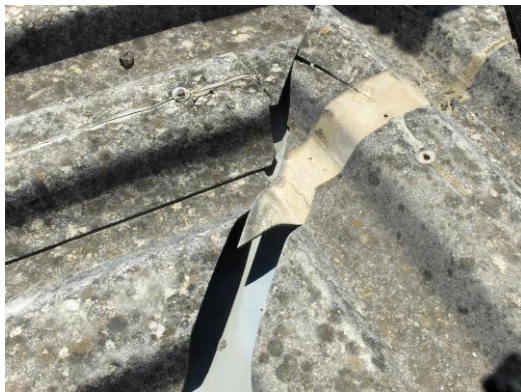
Foto 72 – Chapas de fibrocimento partidas e fissuradas, sem tratamento com solução aquosa de encapsulamento.
