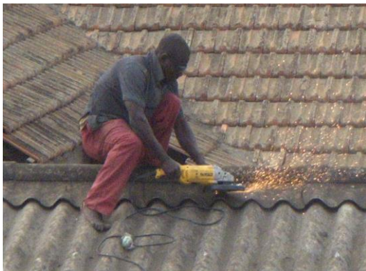
Foto 76 – Remoção de fibrocimento sem qualquer tipo de equipamento colectivo ou individual. Corte de grampos com máquina de disco, a ferir a chapa.
