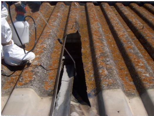
Foto 71 – Chapas de fibrocimento partidas sob o peso do trabalhador, por falta de pranchas de protecção.
