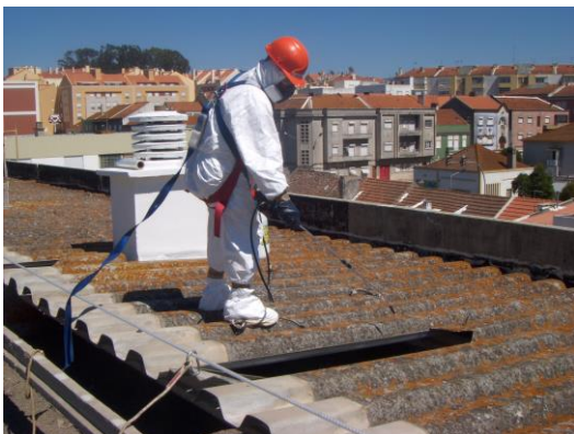
Foto 34 – Remoção de fibrocimento pelo exterior. Aplicação da solução aquosa para o encapsulamento, com recurso a pulverizador.
