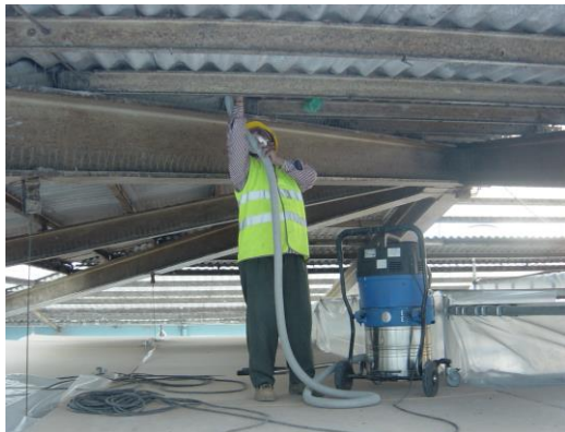
Foto 81 – Aspiração, com equipamento adequado de filtro absoluto, mas trabalhador sem EPI's adequados.
