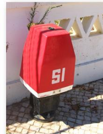
Marco de água (Serviço de Incêndios)
