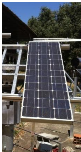
Figura 5.5: Painel fotovoltaico Isofotón M-55 L do sistema do LNEG
