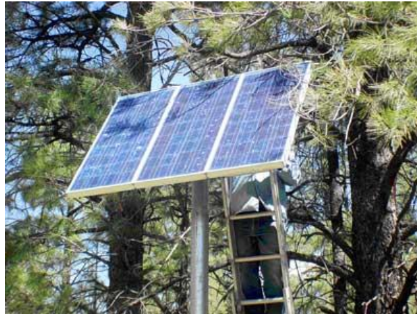
Figura 3.6: Sombras no Painel Fotovoltaico [37].
