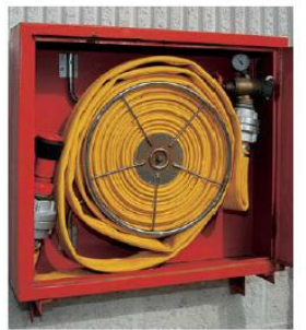
Figura 35 - Boca de Incêndio Armada (Fonte: Rodrigues et al, 2005)
