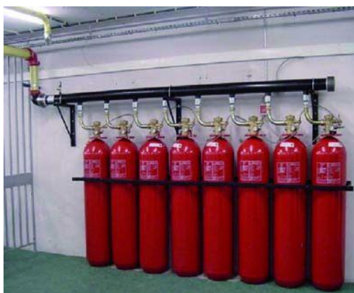
Figura 33 – Botijas de um sistema de extinção por gases (Fonte: http://www.depimex.com )
