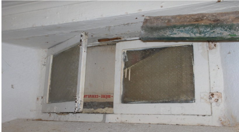
Figura 7 – Exemplo de vão emparedado por construções abusivas do vizinho
