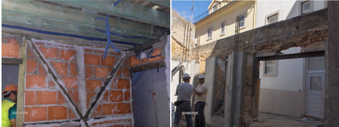
Figura 12 – Esq. Reforço estrutural com reparação de paredes resistentes frontal e substituição do preenchimento de vazados, paredes periféricas cintadas com perfil metálico, reforçadas com lâmina de betão projetado armado com malha de aço distendido grampeado.
