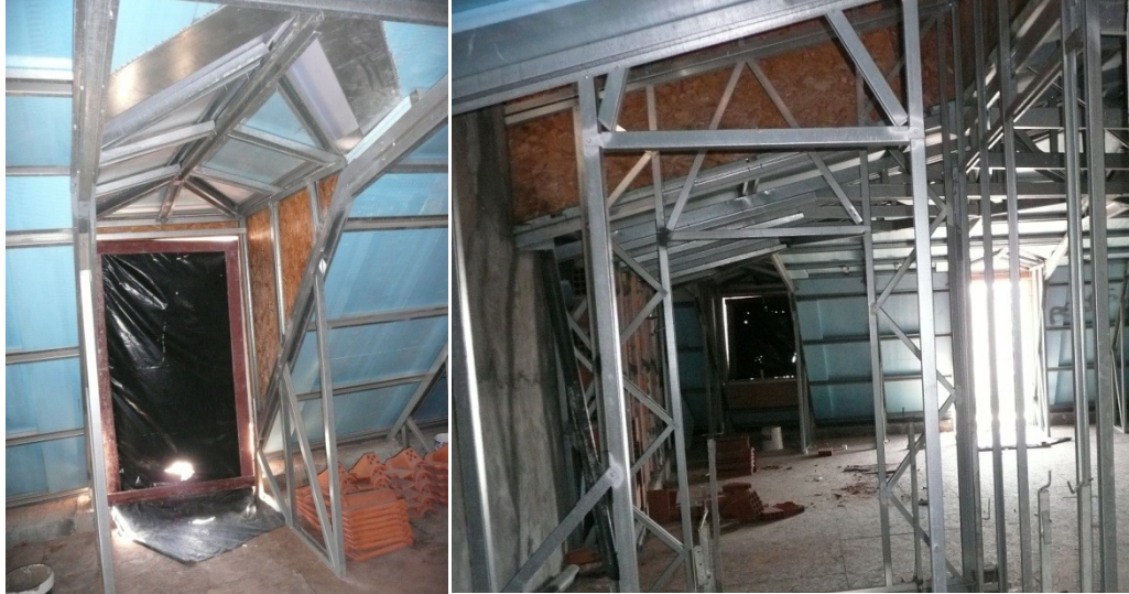
Figura 15 - Vista interior da estrutura em "aço leve" de uma trapeira e de uma cobertura com mansarda.
