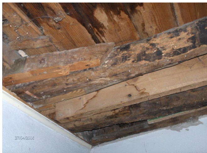
Figura 4 – Exemplo de pavimento danificado devido a infiltrações
