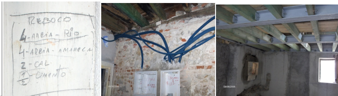
Figura 24 – Esq. Ensaio da composição do reboco escrita numa parede
