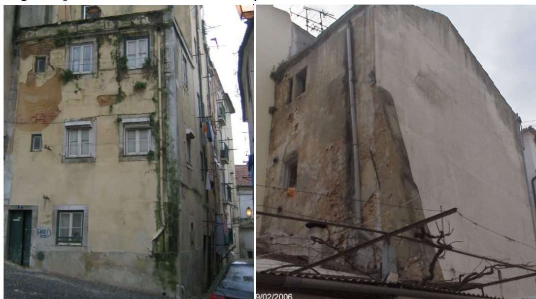
Figura 3 – Exemplos de edifícios com, rebocos degradados, infiltrações e tubos de queda danificados.
