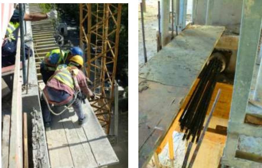
Figura 52 - Operação sem guarda corpos e deficiente plataforma de trabalho
