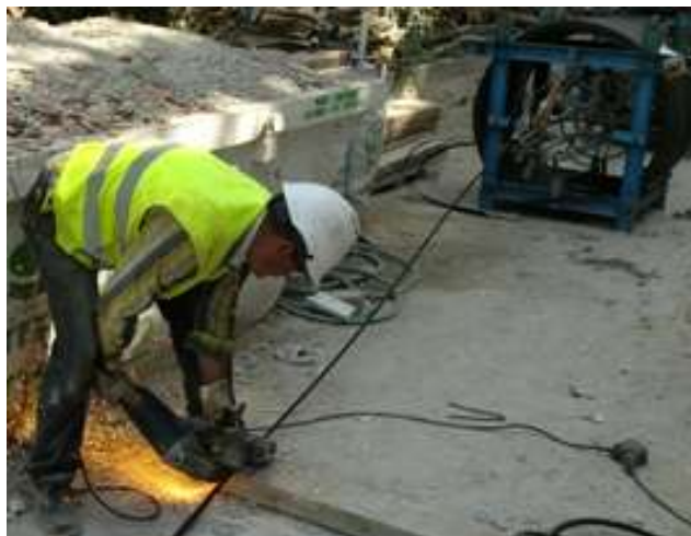
Figura 54 - Trabalhador efectua corte dos cabos sem óculos de protecção
