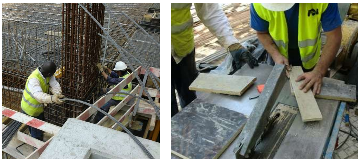
Figura 53 - Falta do capacete e luvas de protecção
