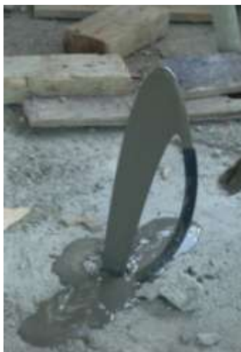
Figura 85 - Calda a sair por tubo de purga
