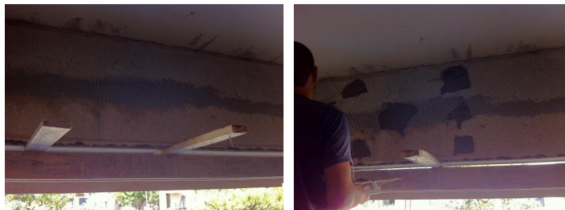
Fig. 5.47 - Reforço com rede de fibra de vidro da união da caixa de estore com parede em alvenaria
