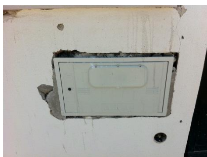
Fig. 5.40 - Caixa exterior para contador da água
