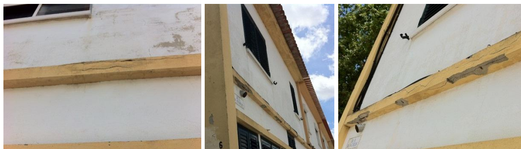
Fig. 3.13 - Degradação e corrosão das armaduras de elementos em betão armado das fachadas
