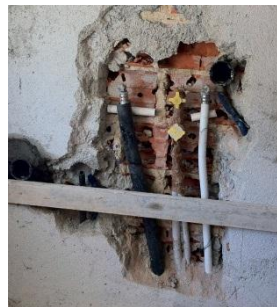
Fig. 5.39 - Tubagens de água e gás em tubo multicamada e tubo em cobre revestido a PVC, respetivamente
