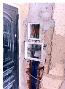
Fig. 5.43 - Caixa ATI da rede ITED
