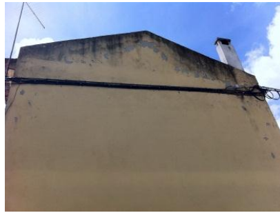
Fig. 3.14 - Degradação dos guarda-fogos e empenas
