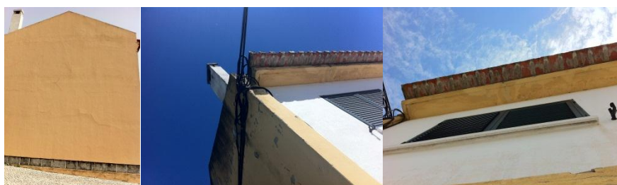
Fig. 3.8 - Degradação de empenas, guarda-fogos e beirados
