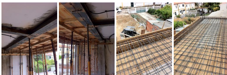
Fig. 5.30 - Cofragem, posicionamento das armaduras e betonagem da laje e pilares do primeiro andar
