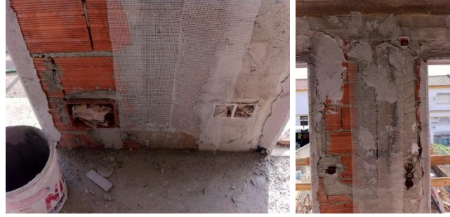
Fig. 5.33 - Rede de fibra de vidro na união do pilar com a parede de alvenaria
