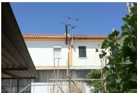
Fig. 3.9 - Deterioração das chaminés das salamandras e antenas
