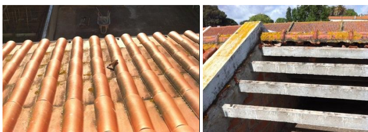
Fig. 3.10 – Degradação e colonização biológica da cobertura
