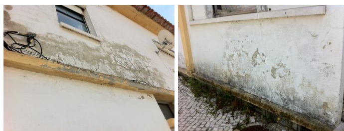
Fig. 3.7 - Degradação das fachadas
