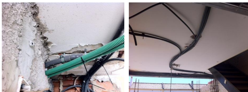
Fig. 5.44 - Tubagens fixas ao teto real
