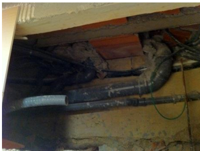
Fig. 5.38 - Tubagens de esgoto em PVC
