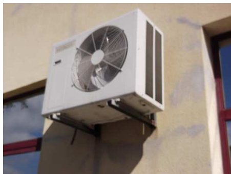
Figura 47. Unidade Compacta de climatização do Edifício DEM-ISEL (Unidade Exterior)
