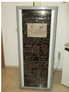
Figura 45. Servidor Central do Edifício DEM-ISEL
