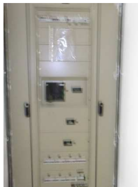
Figura 40. Quadro Geral de Baixa Tensão do Edifício DEM-ISEL
