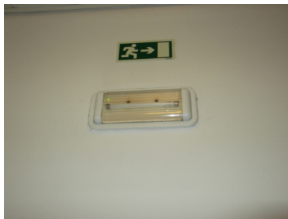
Figura 54. Iluminação de Emergência do Edifício DEM-ISEL
