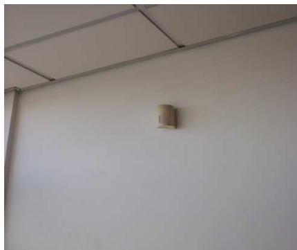
Figura 46. Detector de Intrusão do Edifício DEM-ISEL
