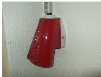
Figura 39. Tomada Trifásica do Edifício DEM-ISEL
