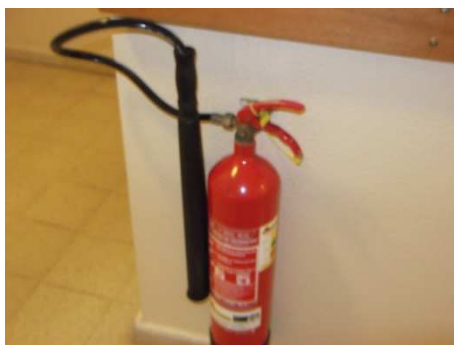
Figura 56. Extintores localizados nos espaços de circulação do Edifício DEM-ISEL
