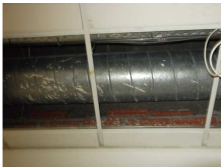
Figura 49. Conduta de extracção do Edifício DEM-ISEL
