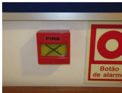
Figura 53. Botões de alarme manuais do Edifício DEM-ISEL
