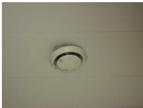
Figura 50. Válvulas de extracção do Edifício DEM-ISEL
