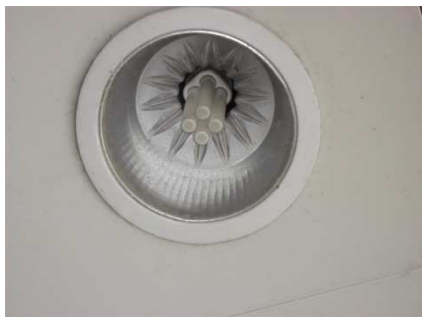
Figura 44. Lâmpadas Fluorescentes Compactas do Edifício DEM-ISEL
