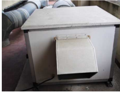
Figura 51. Unidade de Ventilação do Edifício DEM-ISEL
