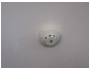
Figura 55. Detectores de Incêndio do Edifício DEM-ISEL
