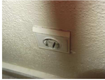
Figura 38. Tomada Monofásica do Edifício DEM-ISEL
