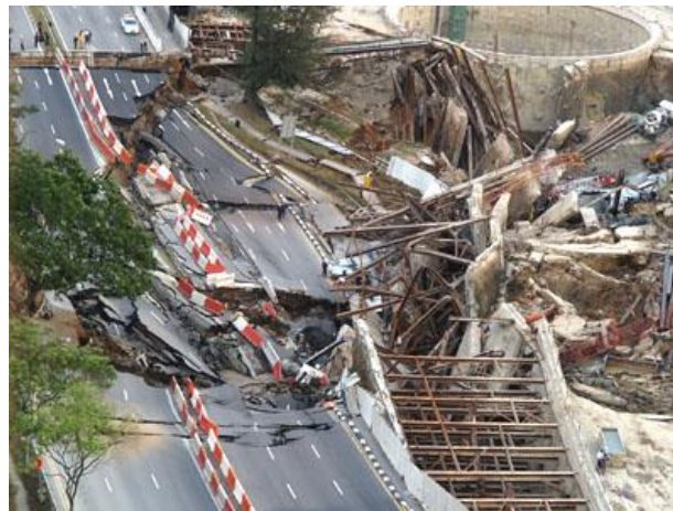
Figura 10 – Colapso no metro de Singapura, 2004, que levou à abertura de um buraco com 30 m na Nicoll Highway, adjacente ao túnel. [http://singaporebuilder.com]
