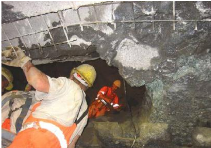
Figura 11 – Resultado de um colapso na abóbada de um túnel durante a escavação. [14]
