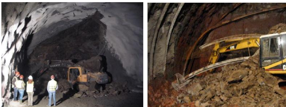
Figura 23 – Desabamento da frente de escavação (à esquerda) e do topo do túnel (à direita). [5]
