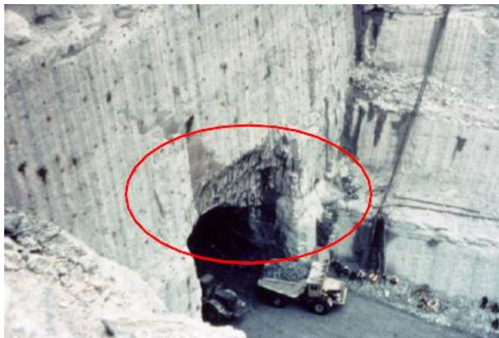
Figura 16 – Colapso do tecto do emboquilhamento de um túnel. [14]
