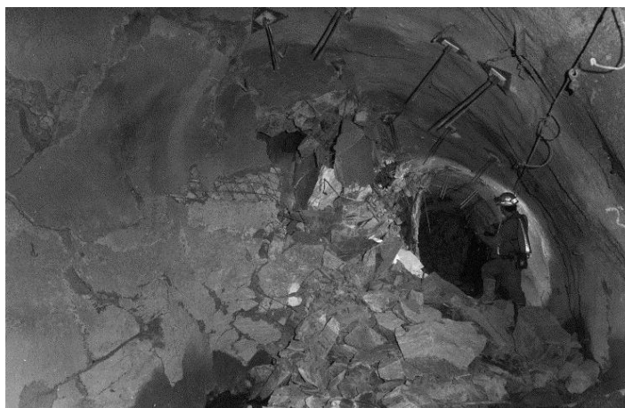
Figura 13 – Danos causados pela ocorrência de rock burst numa mina na África do Sul. [ http://sciencedirect.com ]
