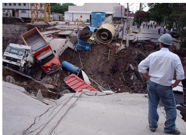
Figura 7 – Engenheiro observa os efeitos do desabamento por ruptura na rocha de um túnel urbano. [6]
