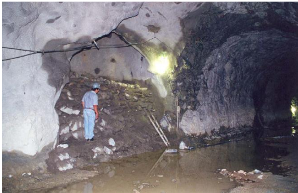
Figura 12 – Colapso da parede lateral de um túnel na Central Eléctrica de Queimado, Brasil, 2002. Foi usada pedra para encher a cavidade onde de seguida se projectou betão. [14]
