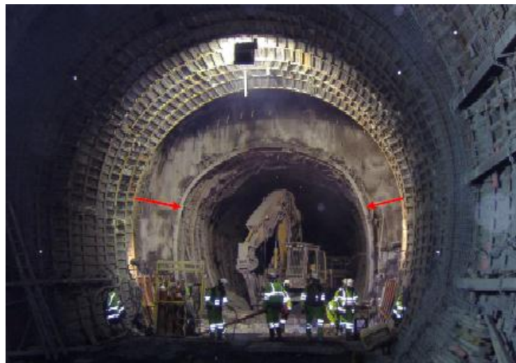
Figura 14 – Ocorrência de squeezing na construção do túnel para a ligação de alta velocidade entre Lyon e Turim. [10]
