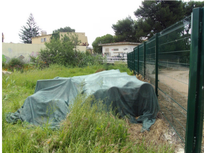
Imagem 24- Tubagem protegida por rede sombreira
