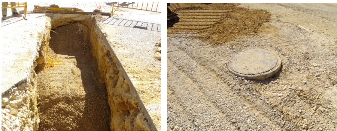
Imagens 60 e 61- Aterro com "tout-venant" por camadas devidamente compactadas, 3ª Fase travessia
