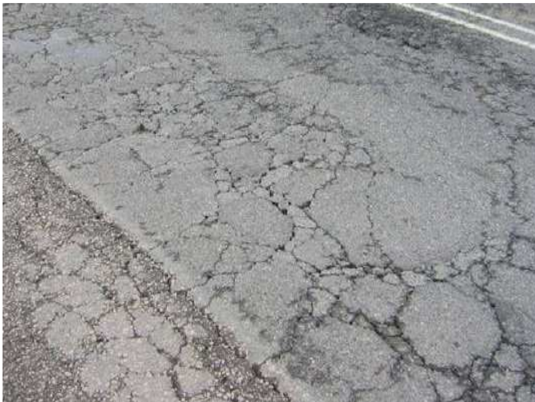
Fig. 50 – Estado de degradação em que se encontrava o pavimento do IP2 antes da obra de reabilitação (Batista, 2004)
