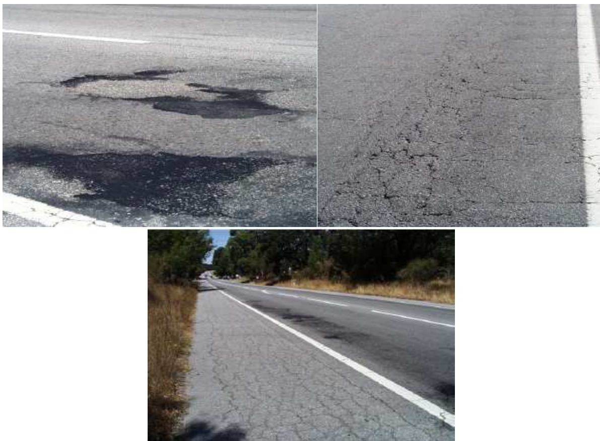
Fig. 53 – Estado de degradação do pavimento (EN 114 – Montemor-o-Novo/nó da A6 Évora)
