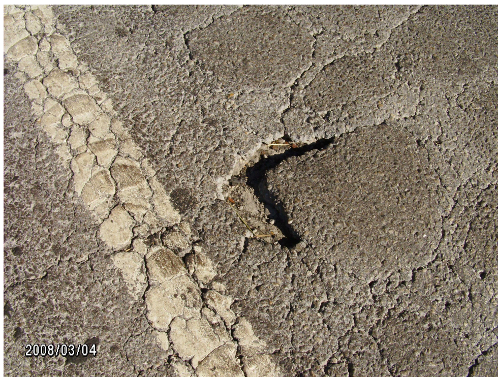
Fig. 60 – Fendilhamento tipo pele de crocodilo com desagregação de blocos
