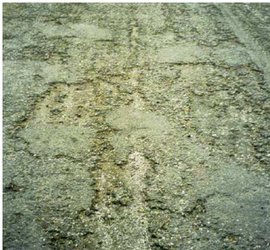
Fig. 41 – Estado de degradação do pavimento da EN 260 antes da obra de reabilitação (Batista, 2004)
