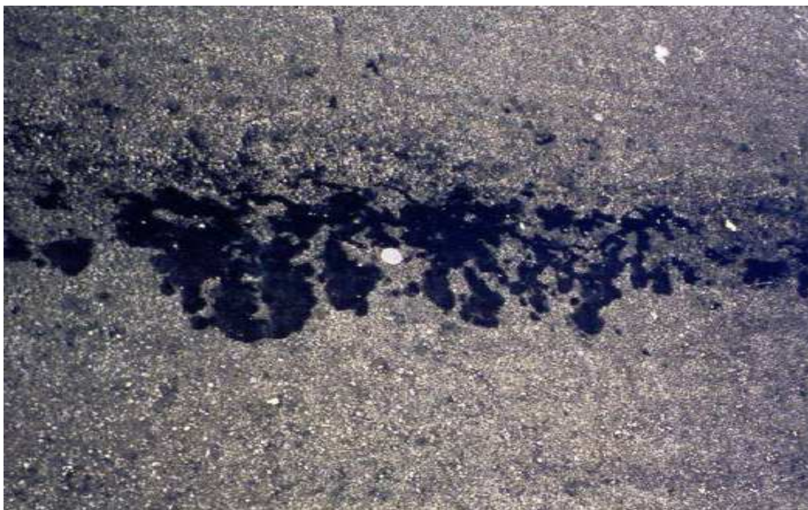
Fig. 46 – Refluimentos de betume do pavimento na EN 260 (Batista, 2004)
