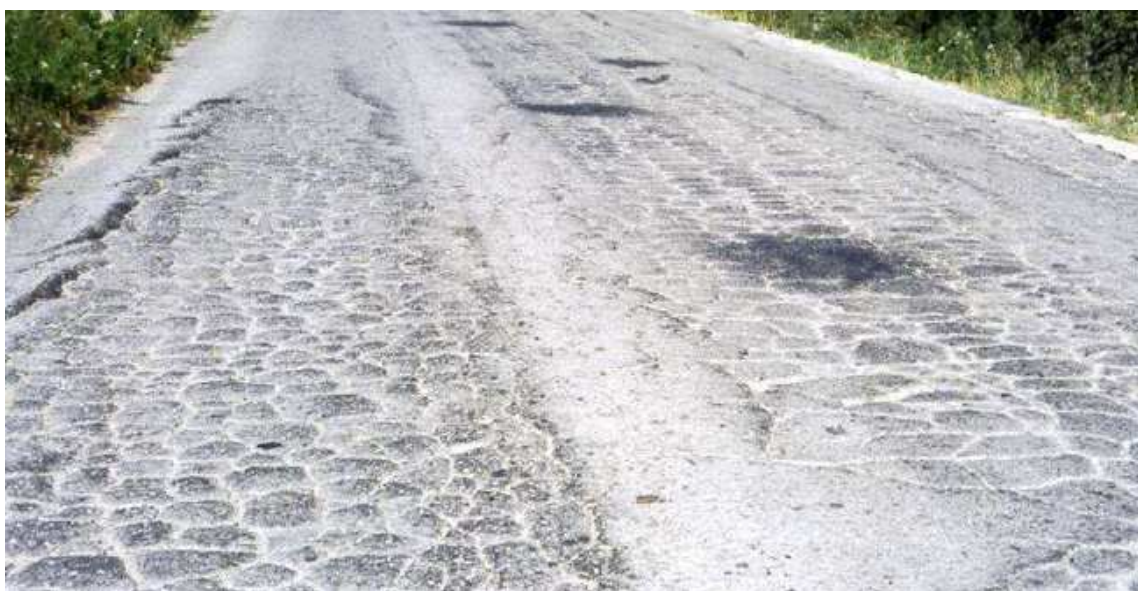
Fig. 38 – Estado de degradação em que se encontrava o pavimento da EN108 antes da obra de reabilitação (Batista, 2004)
