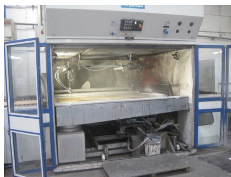
Figura 82 – Cabine de pintura por pistolas
