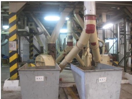
Figura 46 – Encaminhamento para os silos
