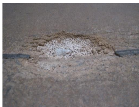
Figura 131 – Deterioração do pavimento
