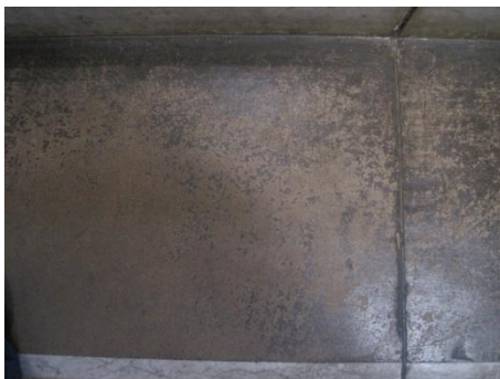
Figura 132 – Alteração da cor do pavimento
