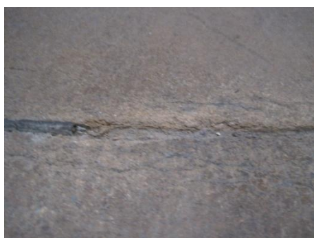
Figura 130 – Desgaste do pavimento
