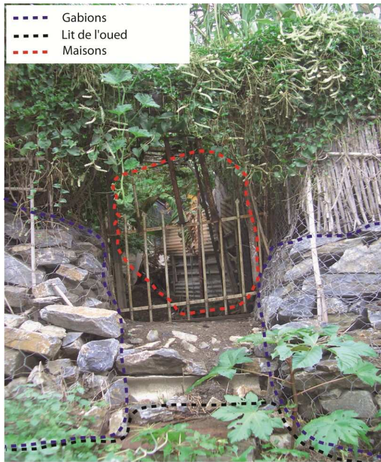
Fig. 7.28. Dégradation du système de gabionnage.
