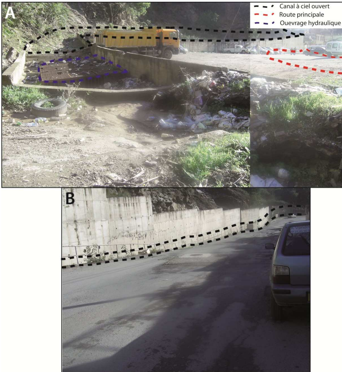
Fig. 7.10. Collecteur à ciel ouvert. A : en aval de l'ouvrage Jaubert ; B : le long de la route qui traverse le quartier ; C : Encombres et embâcles formés par différents matériaux.
