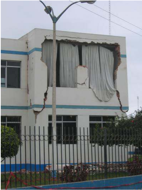
Photo 4 - Destruction partielle de l'hôpital Rene Toche Groppo (Chincha Baja)
