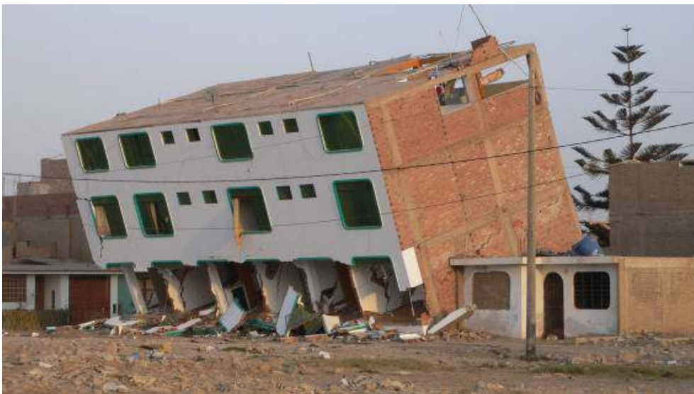
Photo 6 - Dommages à un édifice récent, mal construit (Pisco)
