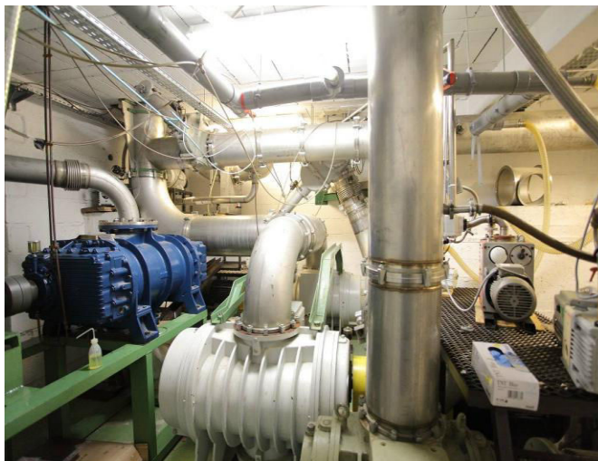
Figure 2.7: Groupe de pompage utilisé pour le dispositif CRESU à Rennes
