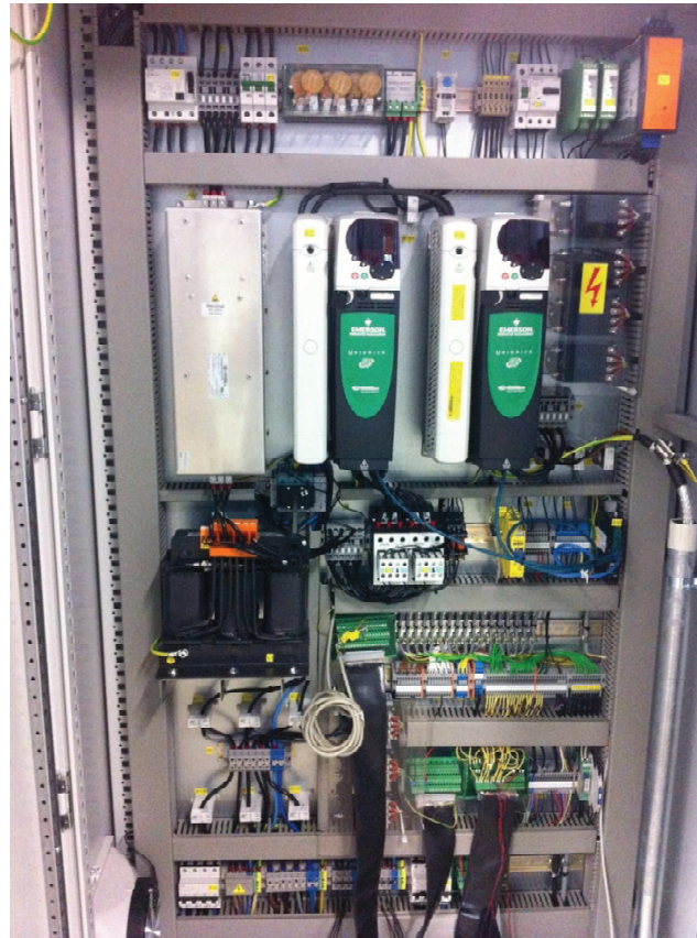
Figure IV-26: Photo de l'armoire de puissance
