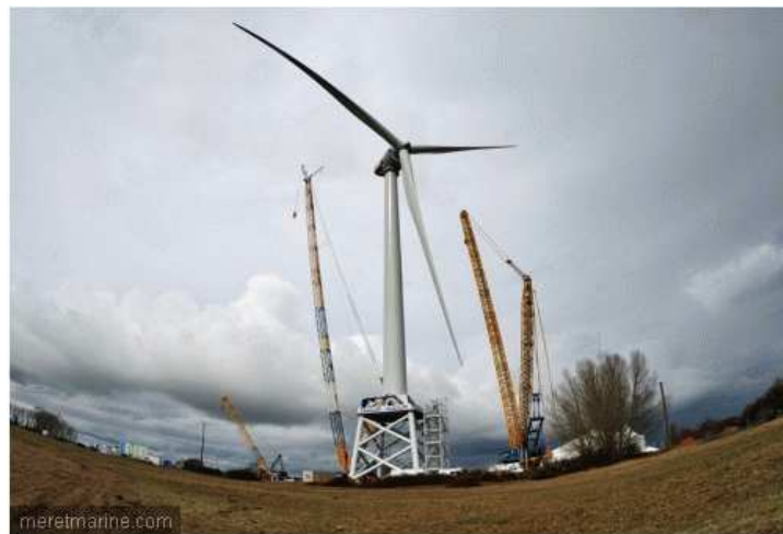
Figure 5.36 Photo de l'éolienne Haliade 150 assemblée [Mer12b]
