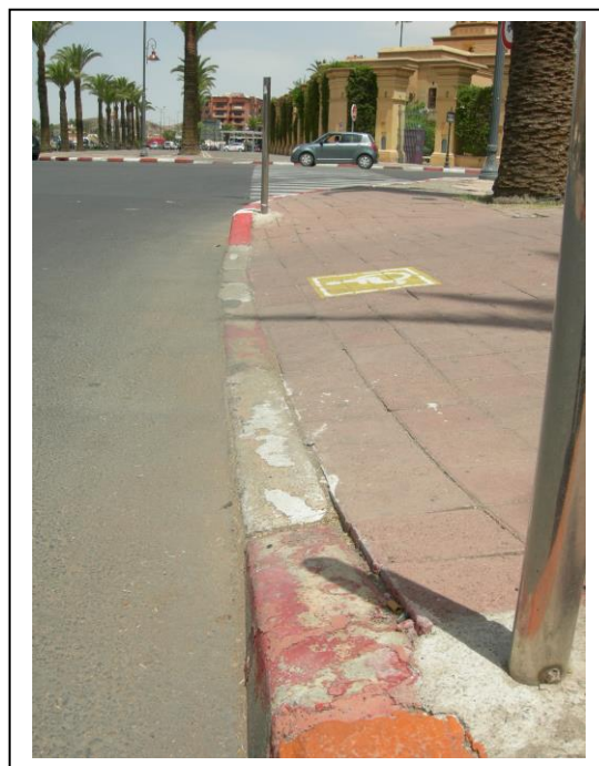
Figure 83. Exemple de bateau bien conçu, av. Mohammed VI, Marrakech. Cliché: A. NAKHLI, 2014.
