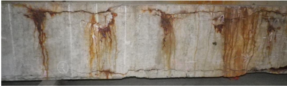
(a) Poutres corrodées B2Cl2 (26 ans)
