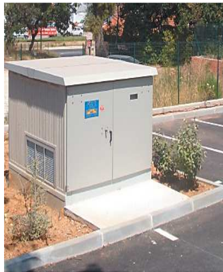
Figure 1.8 : Poste de distribution HTA/BTA type « cabine ».
