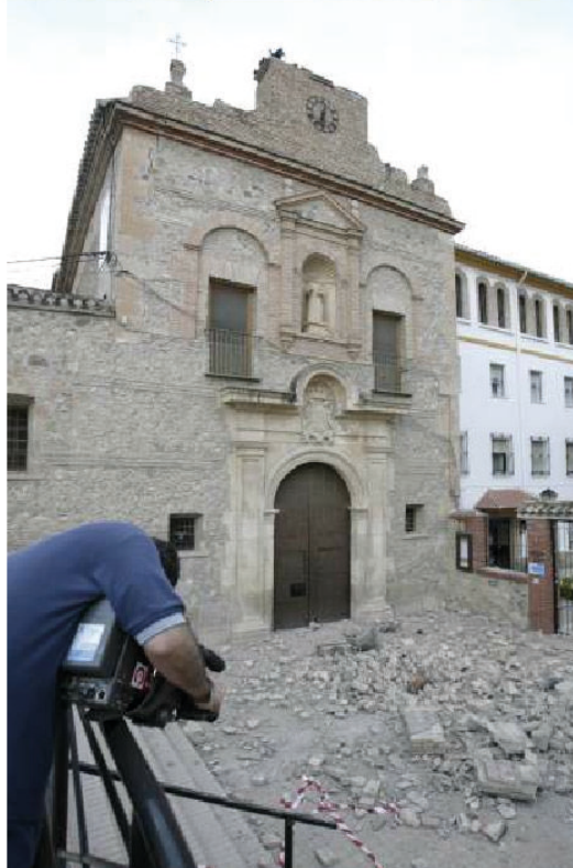
Figure 24. Séquence d'images de la chute du clocher pendant le deuxième séisme quand un journaliste de TV1 est en train d'interviewer des témoins de la première secousse. Le clocher tombe à quelques mètres de lui. Dans la dernière image nous observons le lieu depuis un autre angle. Sources : (TV1) et la photo en bas (Juan Francisco Moreno / EFE).
