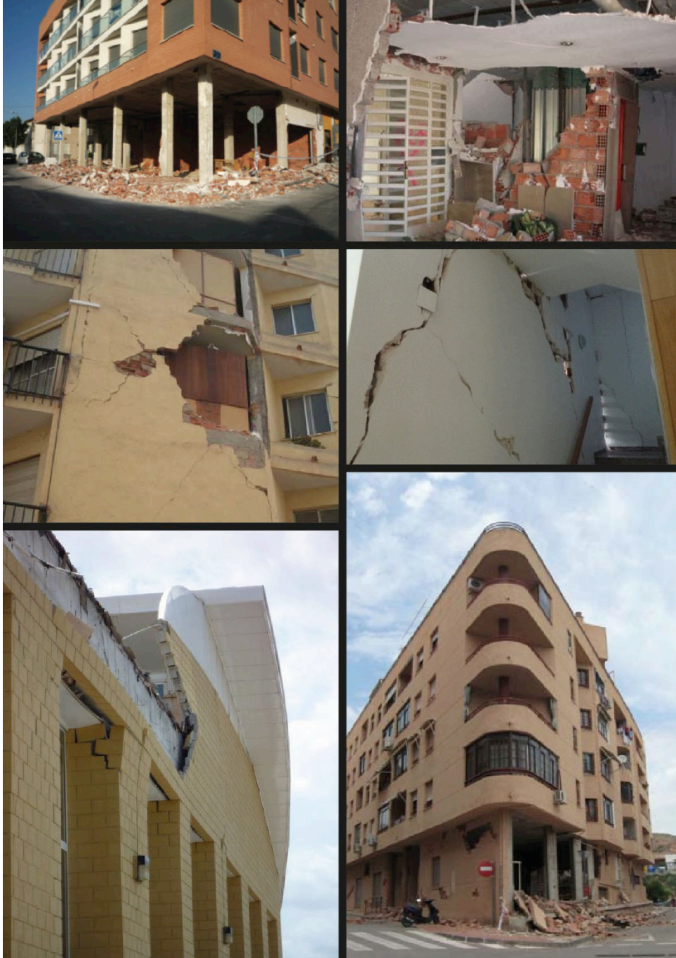
Figure 31. Exemples de dommages non structuraux. Nous pouvons en trouver à différentes hauteurs, à l'intérieur ou à l'extérieur des bâtiments (M. Feriche).
