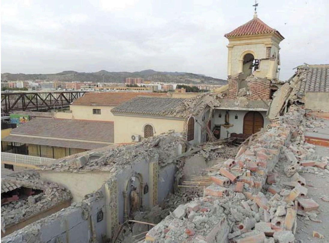
Figure 23. Eglise du Monastère de las Clarisas , suite au séisme (Martínez 2012).
