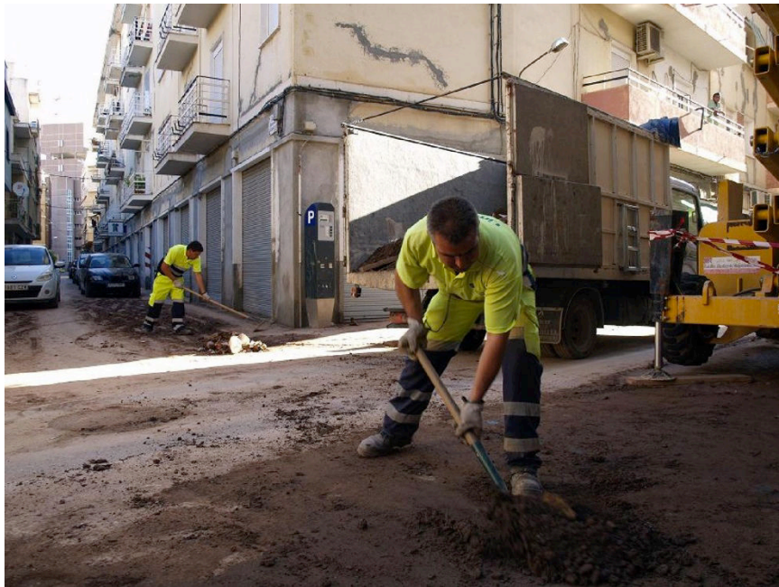
Figure 20. Des travailleurs de la mairie enlèvent la boue après les inondations du 28 septembre 2012. Derrière eux, sur les murs des bâtiments, de nombreuses fissures déjà bouchées, ainsi que les piliers refaits à cause du séisme de l'année précédente, montrent le caractère multirisque de la ville. Source : Ayuntamiento de Lorca .
