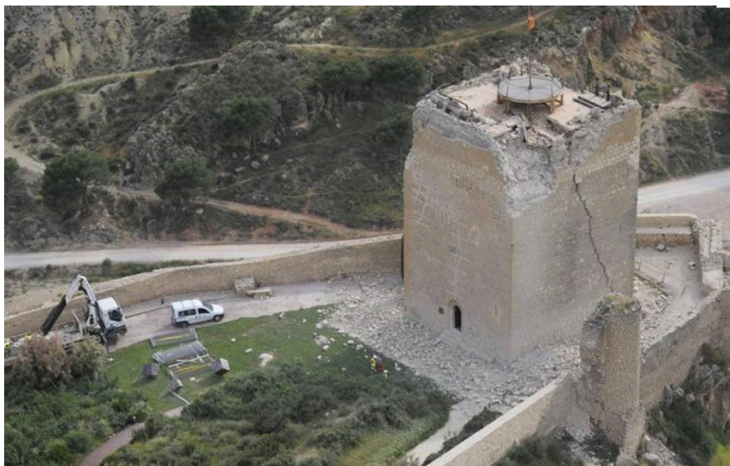
Figure 21. Image aérienne de la tour du château de Lorca qui a souffert d'importants dégâts, notamment dans les coins supérieurs. Source : El País.
