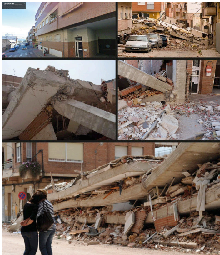
Figure 30. Images du seul bâtiment que s'est effondré. En haut à gauche, une image extraite de Google Maps montre le bâtiment avant le séisme ; les autres montrent les dégâts après la secousse. Sources : Libertad digital, la Vanguardia, Itesia .
