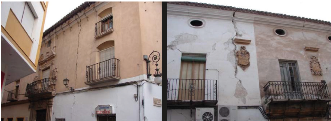
Figure 29. A gauche, bâtiment de trois étages de 1800. A droite, bâtiment de 1910 avec le même type de fissure verticale (J. Perez Mueles).
