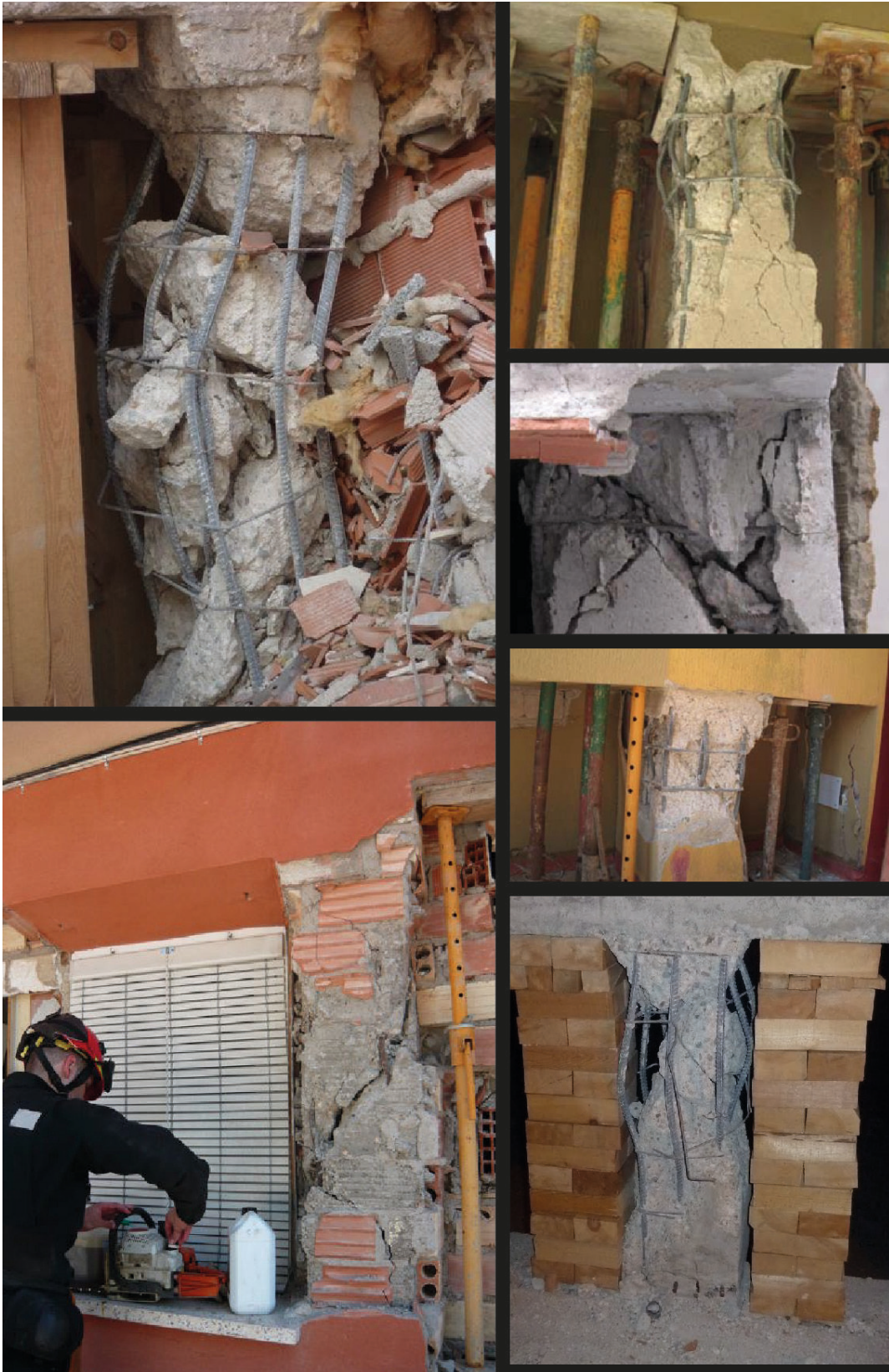
Figure 28. Exemples de dommages sur des piliers. Auteurs : Patrick Murphy et Adrian Tomas Alarcon.
