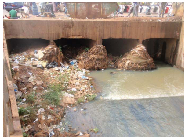
D : Digues de déchets dans le Mfoundi au Centre ville
