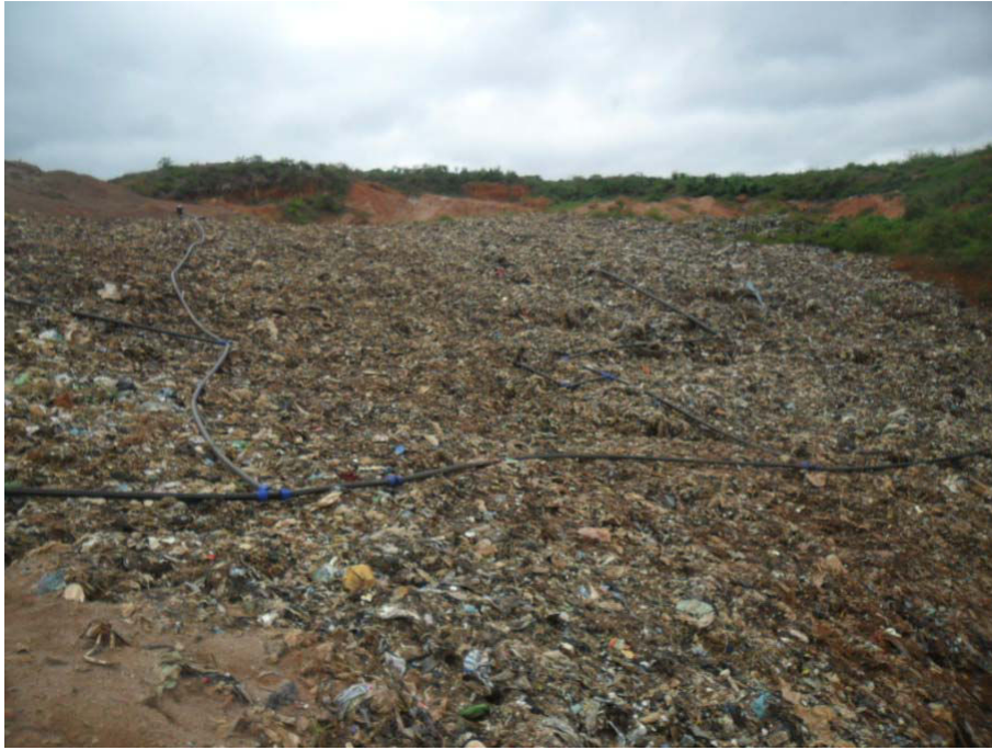
Photo 9: Réseau de collecte de biogaz à la décharge de Nkol Foulou
