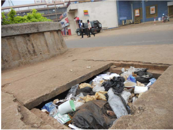
A. Egout bouché au Centre ville
